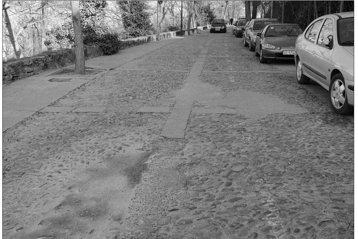
El pavimento del Paseo San Juan de la Cruz presenta serias deficiencias desde hace bastante tiempo. / FERNANDO PEÑALOSA
