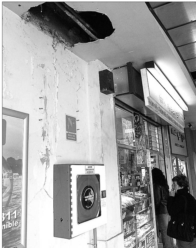
Agujero en el techo de casi un metro de diámetro/JUAN MARTÍN
