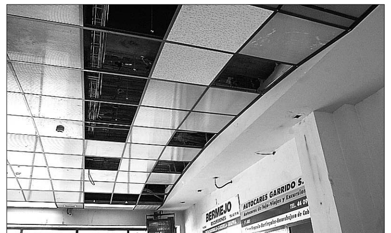
Faltan paneles en los techos y los cables permanecen a la vista/JUAN MARTÍN
