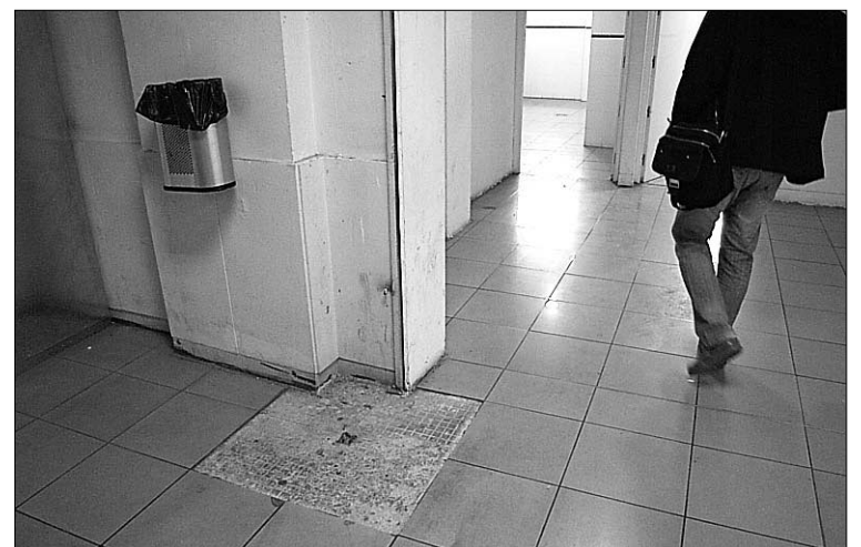
Algunas baldosas están levantadas ofreciendo un lamentable aspecto/J.MARTÍN
