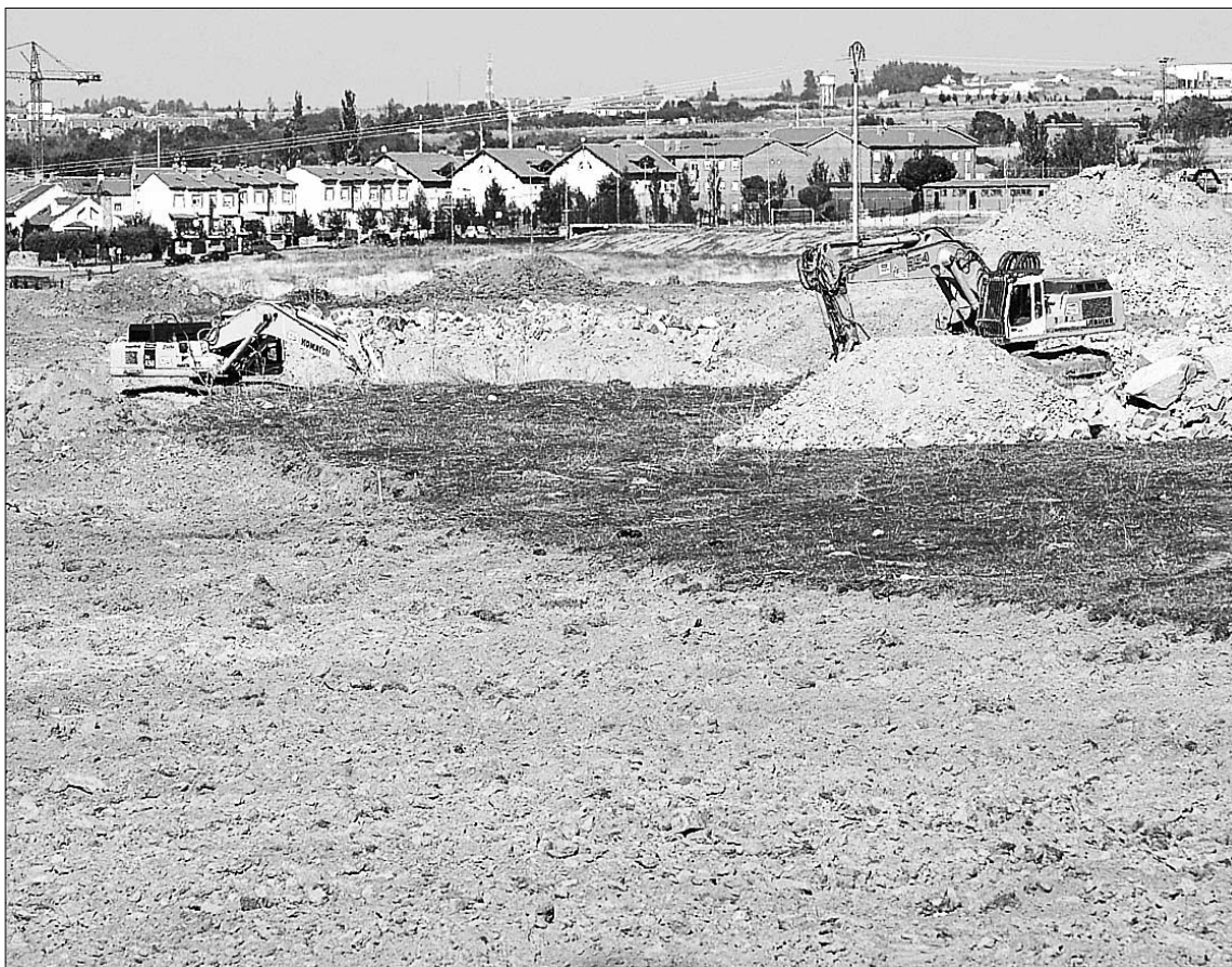
Las máquinas ya han empezado a trabajar sobre el terreno en la primera fase del proyecto. //JUAN MARTÍN
