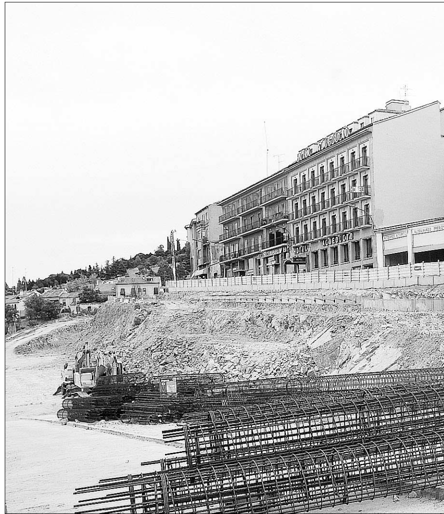
Las obras de excavación del aparcamiento estarán ultimadas a principios del próximo otoño, momento en el que se empezará a construir la estructura del parking.
