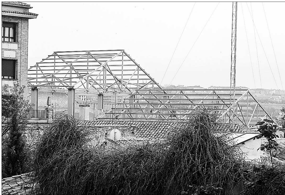
La Junta paralizó las obras del teatro Cervantes en marzo del pasado año al detectar un exceso de altura y volumen/KAMARERO
