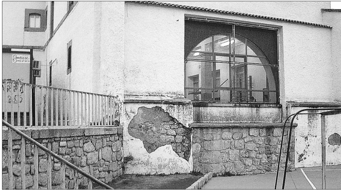
Estado actual de parte de las instalaciones del colegio Arcipreste de Hita de El Espinar. /PEDRO L. MERINO
