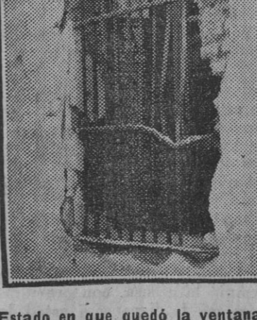
Estado en que quedó la ventana de la casa Santa Teresa, 10, después de la explosión. (Foto, S. del Pando.)
