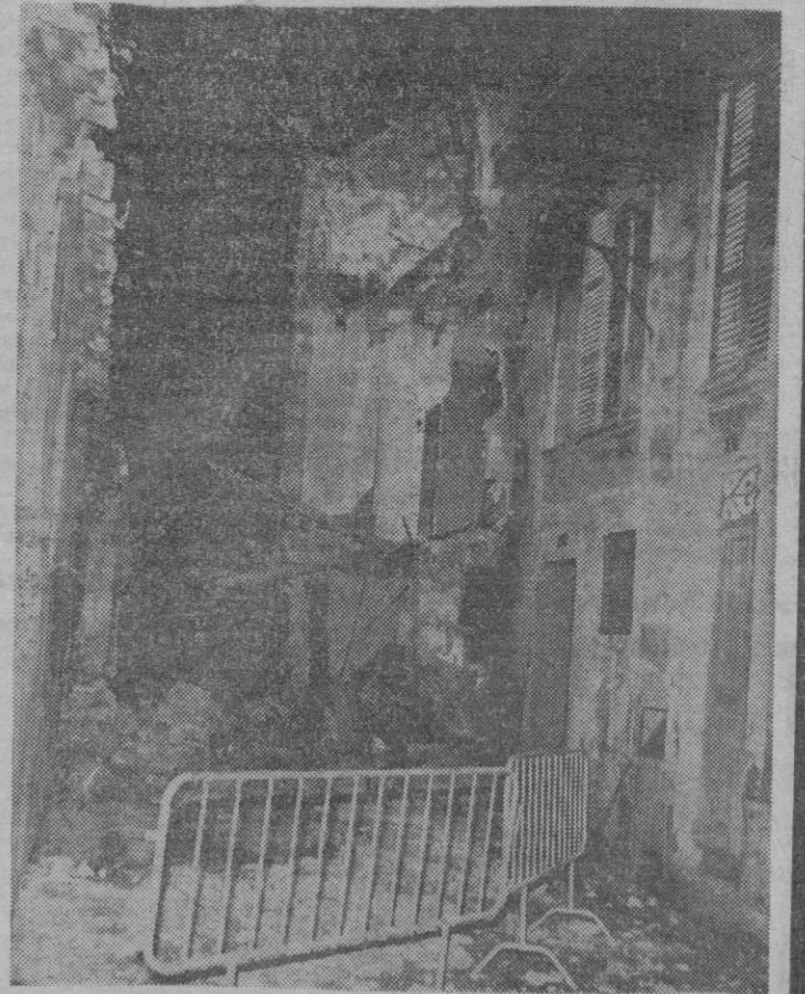
En la mañana de ayer se derrumbó una vieja casa situada en la calle Estacada de nuestra ciudad, en pleno corazón del «barrio», entre las calles Santanyi y Manteros. Puesto que el edificio se ocupaba circunstancialmente en horas de la noche, la ausencia de inquilinos de día evitó el que se produjera alguna víctima. La suerte quiso también, que por el estrecho callejón, más que calle, no transitara nadie ya que la calzada quedó bloqueada por la caída de los materiales, como se muestra en la fotografía de «Pascual». Más información en página de «Sucesos».
