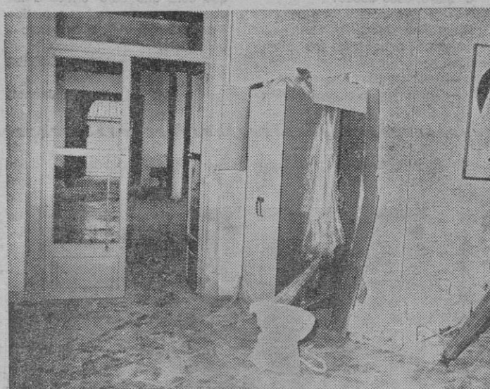
La entrada del colegio del Coll D'en Rebassa. Desde las vacaciones, las obras siguen paradas.
