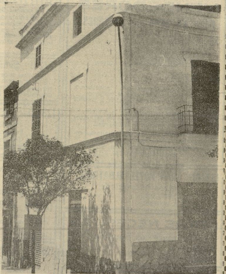
Una de las modernas farolas que han sido instaladas.
