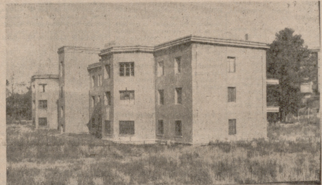
El inmueble que fue Pabellón de Niños en la Magdalena, está deshabitado. Y parece que dentro de poco tiempo estará desconocido por dentro y por fuera, si no hay antes demolición o si no se establece una vigilancia adecuada.—(Foto Carvajal.)
