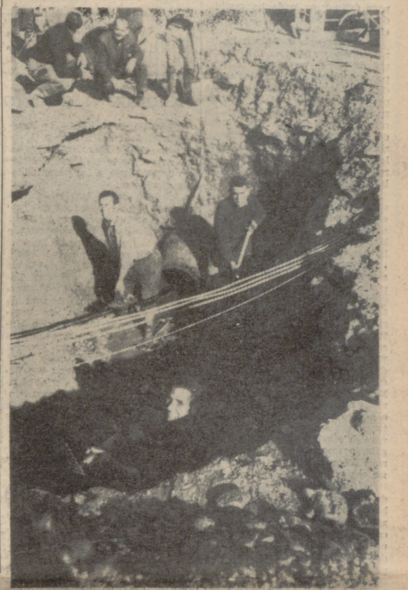
Anoche, a las diez y media, se produjo una grave avería en una conducción de agua que atraviesa el túnel de las Delicias, a consecuencia de la cual las aguas inundaron por completo el paso de peatones y en menor cantidad el destinado a vehículos. Esta mañana el agua había desaparecido, gracias a la labor de los bomberos. Brigadas de obreros continúan los trabajos de reparación, que esta tarde quedarán terminados.
