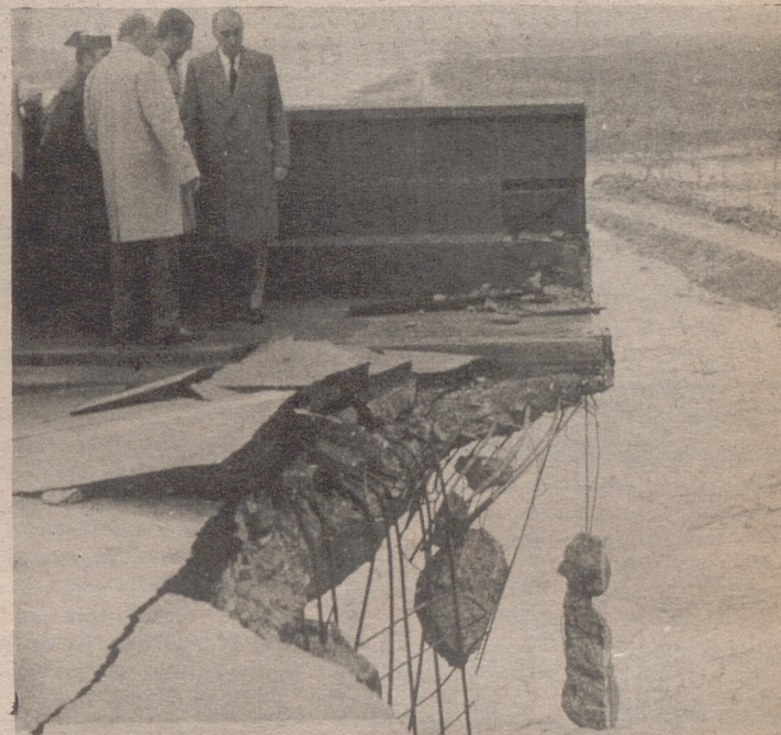
BARCELONA.— El puente de Molins de Rey, en la carretera nacional II fué destruido en parte por la fuerza de la Riada. Vemos el corte en el mismo, que fue visitado por el ministro de la Gobernación.
