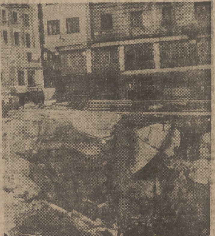
Así ha quedado el aparcamiento subterráneo de la plaza de los Mostenses, que iba a ser inaugurado dentro de un mes, después del hundimiento de sus tres plantas
