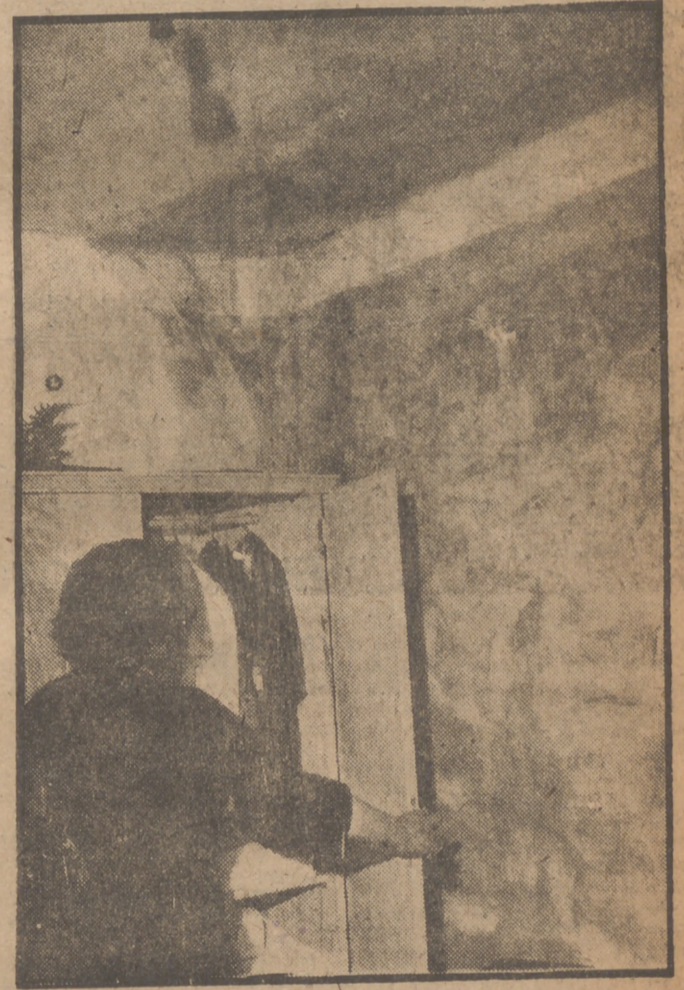
Las viviendas de los pisos altos son las que más acusan las deficiencias de construcción. Compruébese la humedad de las paredes y del techo. Ni los muebles ni las ropas pueden sustraerse a la acción demoleadora del agua que se filtra, indica la apenada inquilina
