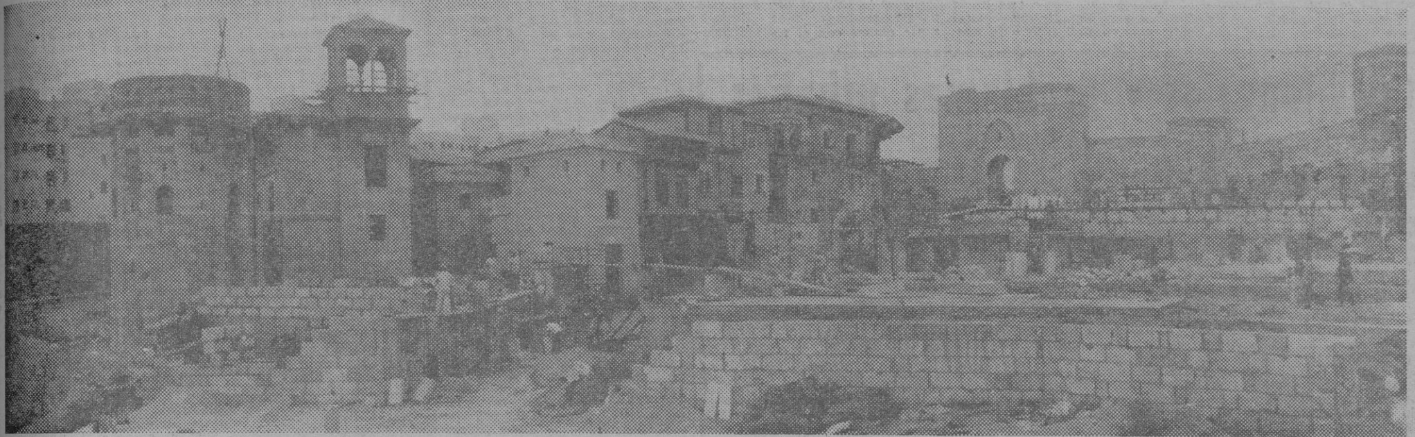
VISTA GENERAL DEL ESTADO ACTUAL DE LAS OBRAS DEL «PUEBLO ESPAÑOL». A LA IZQUIERDA LA TORRE DEL ORO, CASI TERMINADA Y AL FONDO LA MORUNA PUERTA DE TOLEDO, DE GUADALAJARA. EN EL ESPACIO ABIERTO SE EDIFICARÁ LA PLAZA AGORA Y CORAZÓN DE ESTA NUEVA-VIEJA POBLACION.
