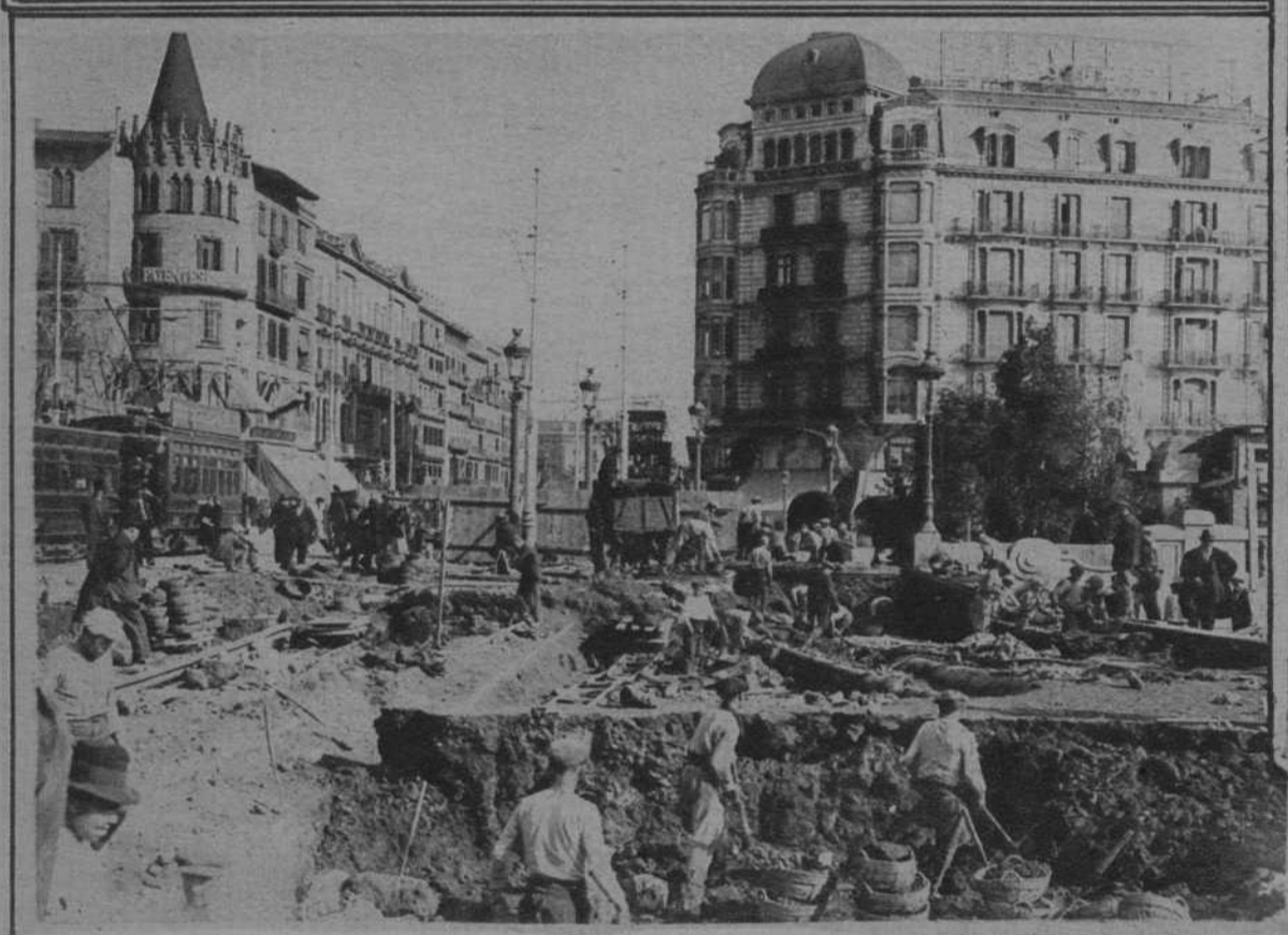
Como es sabido han comenzado las obras de construcción, en la plaza de Cataluña, de la estación subterránea de la Compañía del Norte. Esta estación permitirá que los grandes expresos europeos rindan viaje en el corazón mismo de la ciudad. De la importancia de las obras da idea la fotografía que publicamos. (Fot. Ritma)
