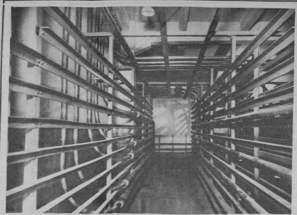
Los cables procedentes de las canalizaciones que llegan por el Paseo de Gracia, calle de Fontanella y Puerta del Angel, se reúnen en esta galería de los sótanos y, convenientemente ordenados, suben por tubos verticales a la base del repartidor.
