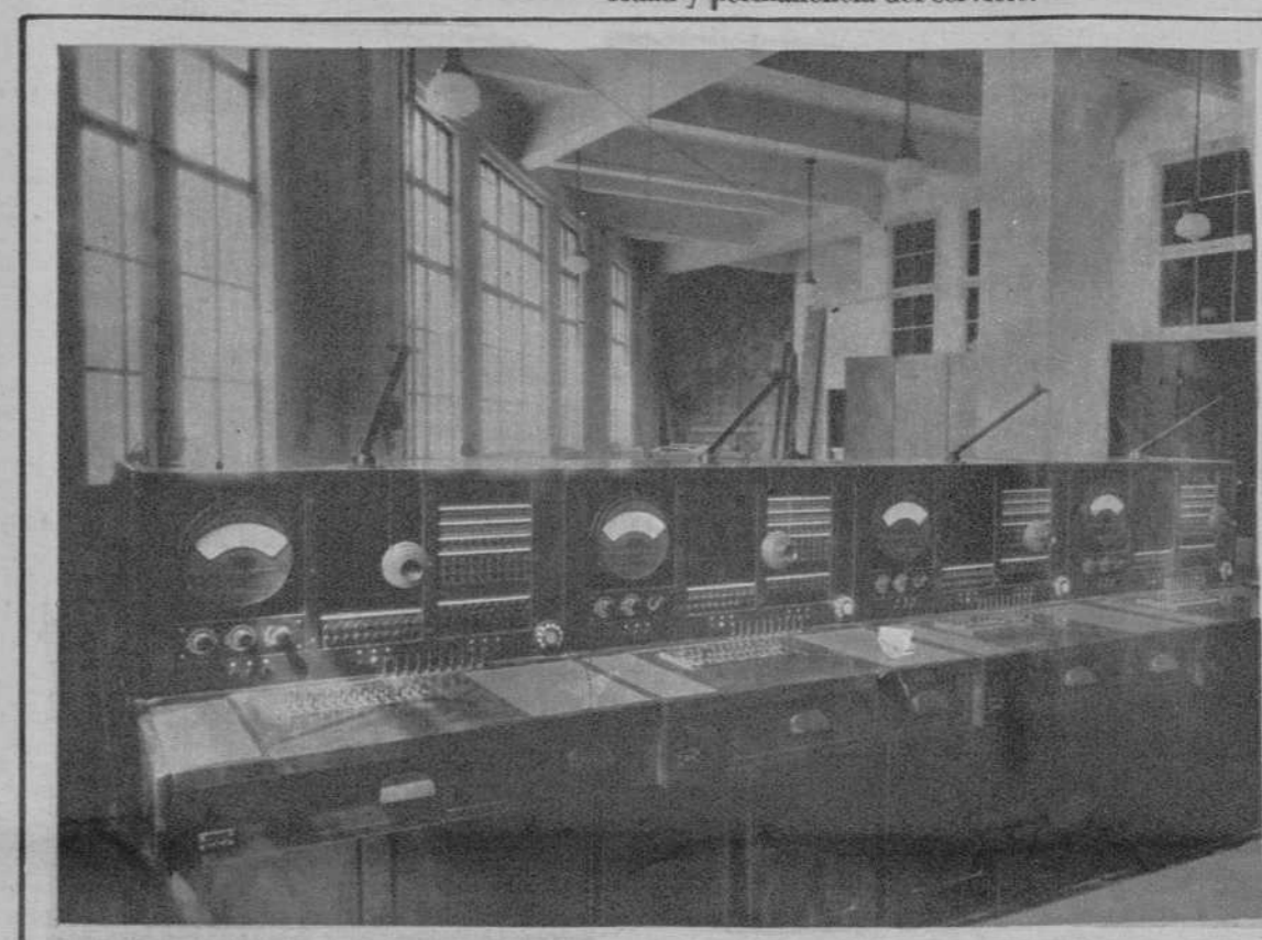
Mesa de pruebas de circuitos urbanos. Toda avería o reclamación pasa a esta mesa de pruebas, donde personal especializado determina la causa de la anomalía, separando las que procedan de faltas en la Central de las de la red exterior.
