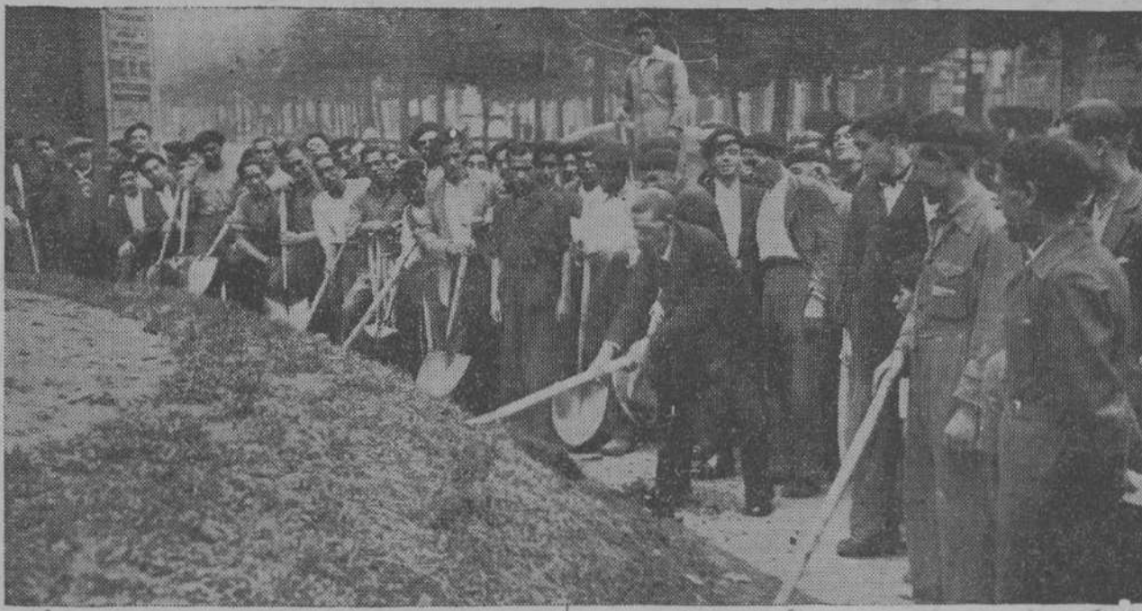
Nuestro alcalde, señor Castillo, empuñó en la mañana de ayer la azada para iniciar los primeros trabajos en la perforación del túnel del pueblo, cuyas obras continuarán hasta dar término a tan importante obra. (F. A.)
