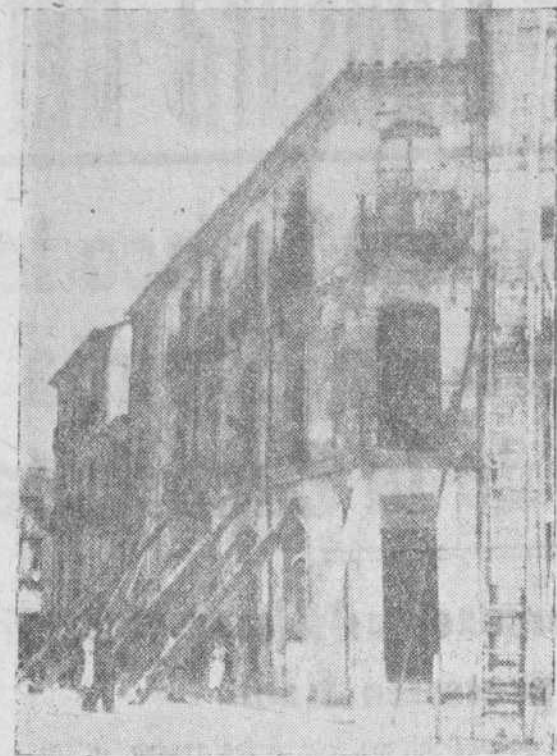
Fachada de la casa donde se ha producido el hundimiento. Foto: Guzmán Gombau
