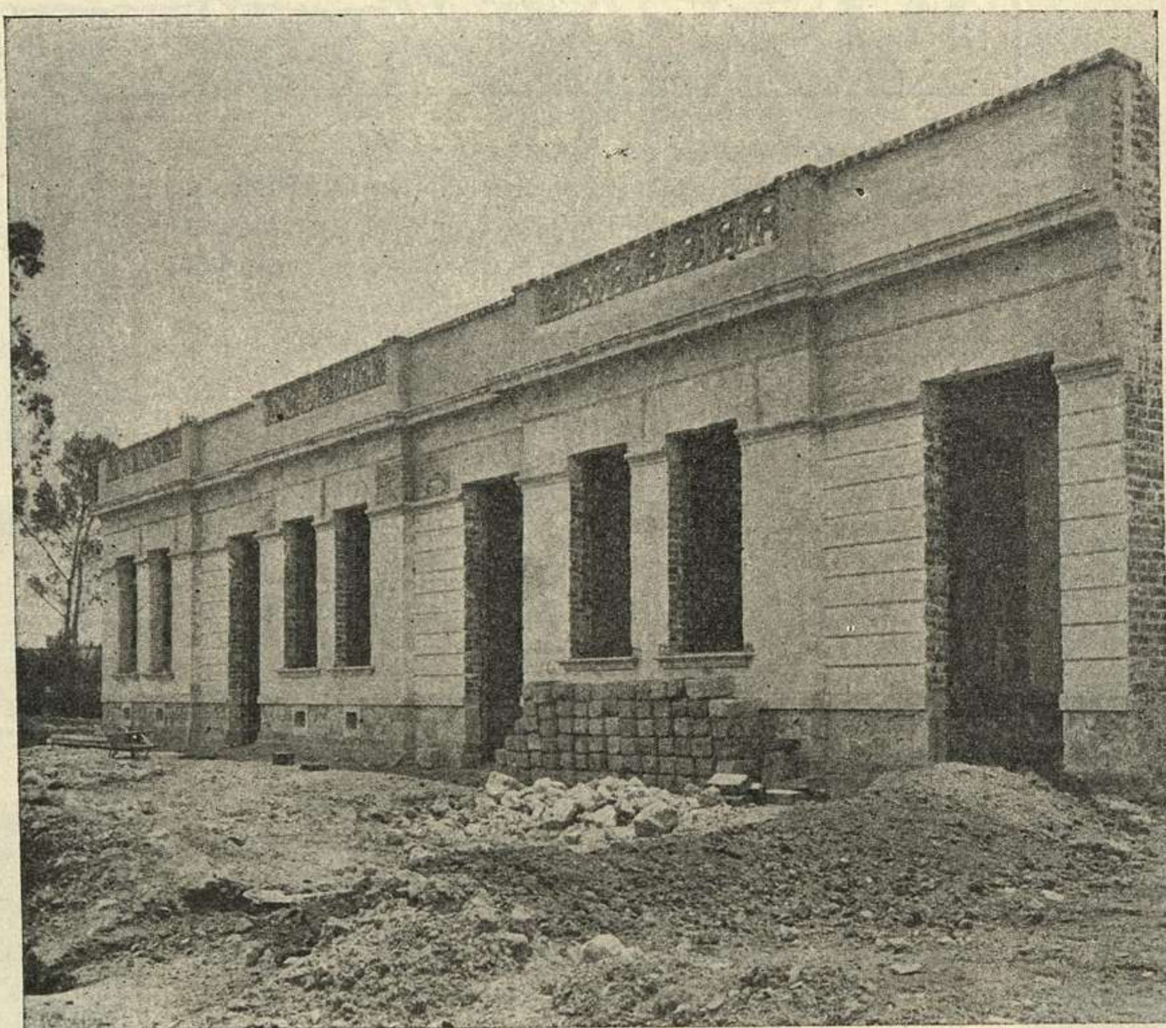
Casa en construcción en la 5ª calle del Naranjo. Propiedad del Sr. Dr. Reyes Bruciaga
