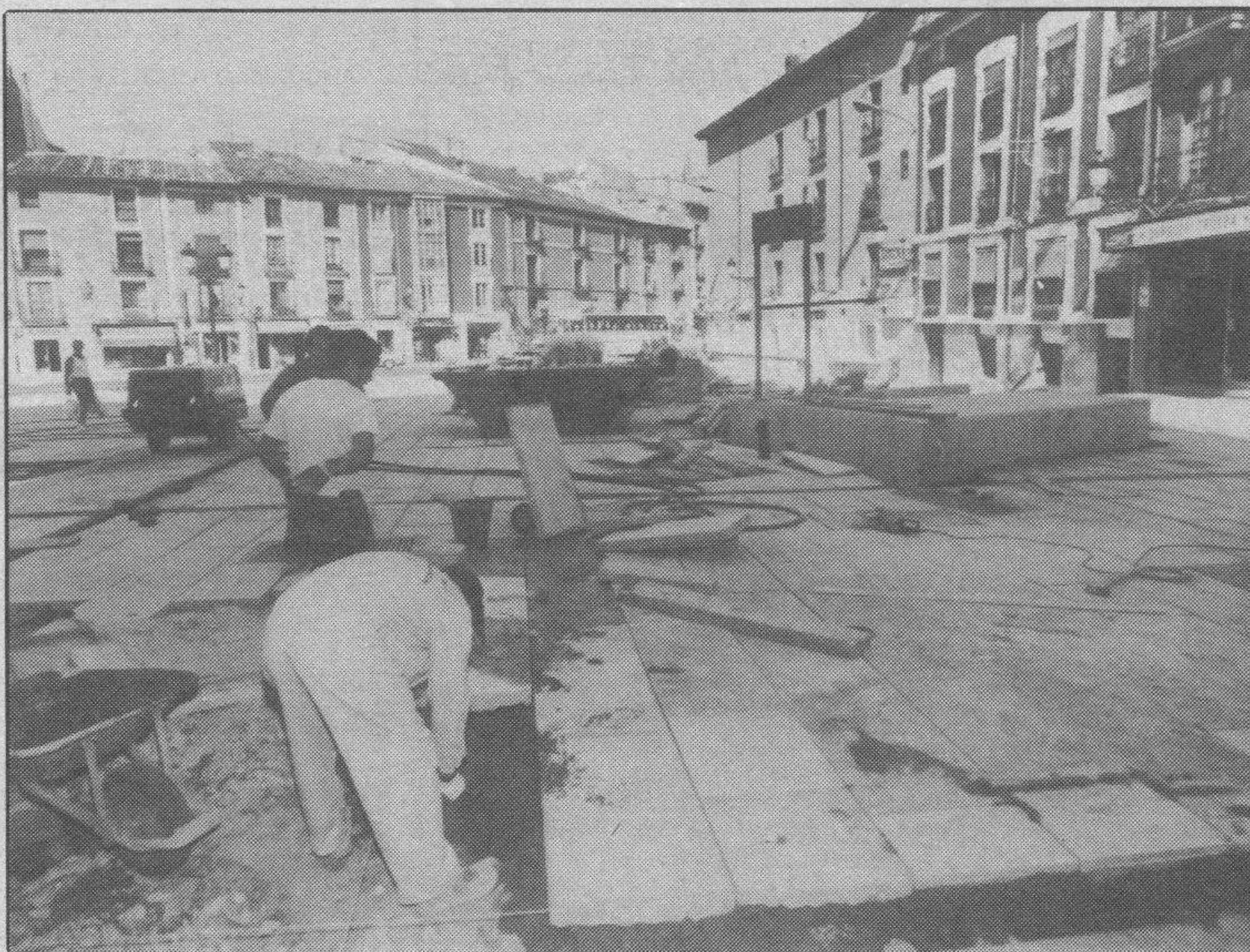
El problema de las losetas retrasa, aún más, el final de la urbanización en la Plaza Vega.
