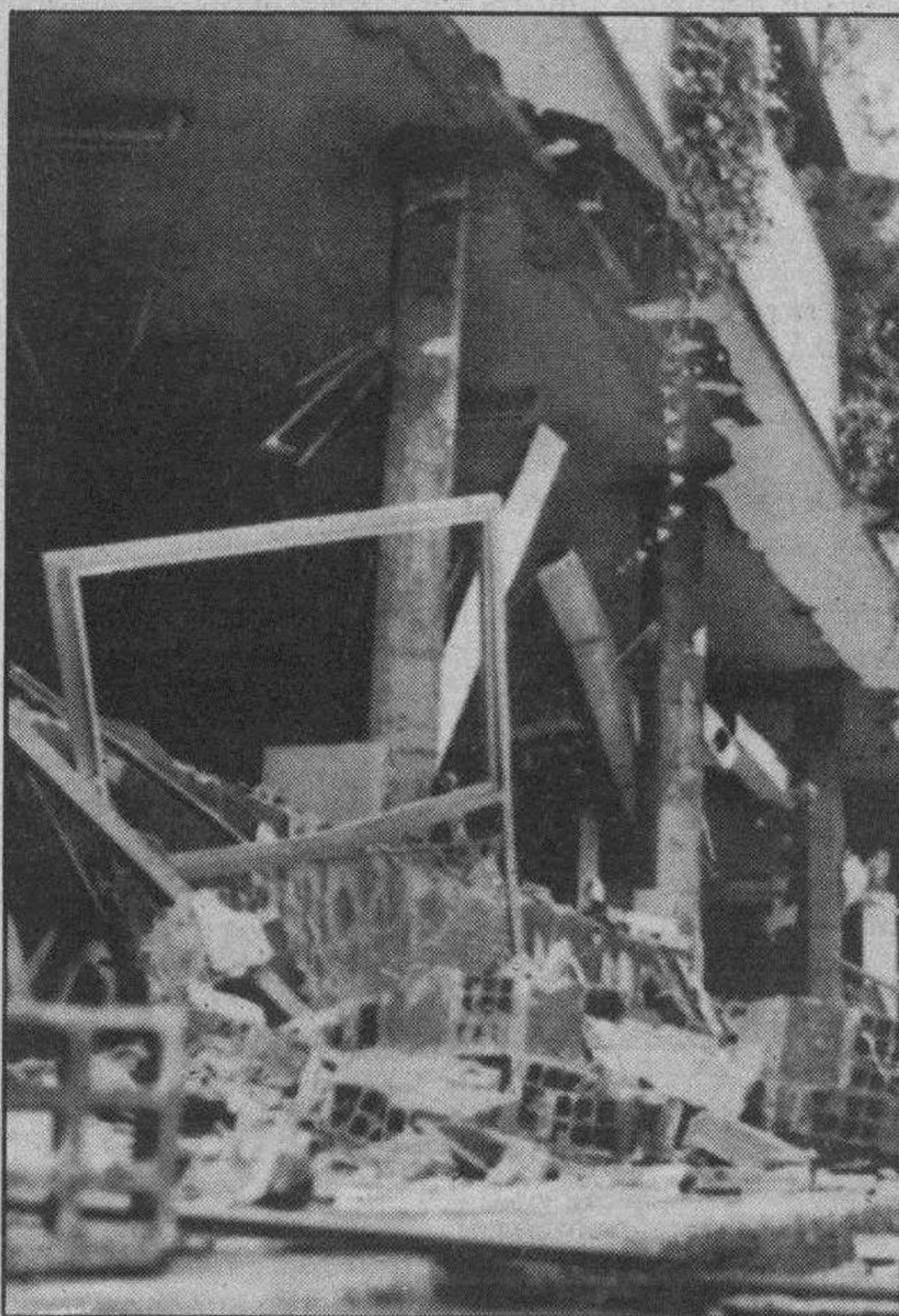
Estado en que quedó la fachada de la Jefatura. Efe
