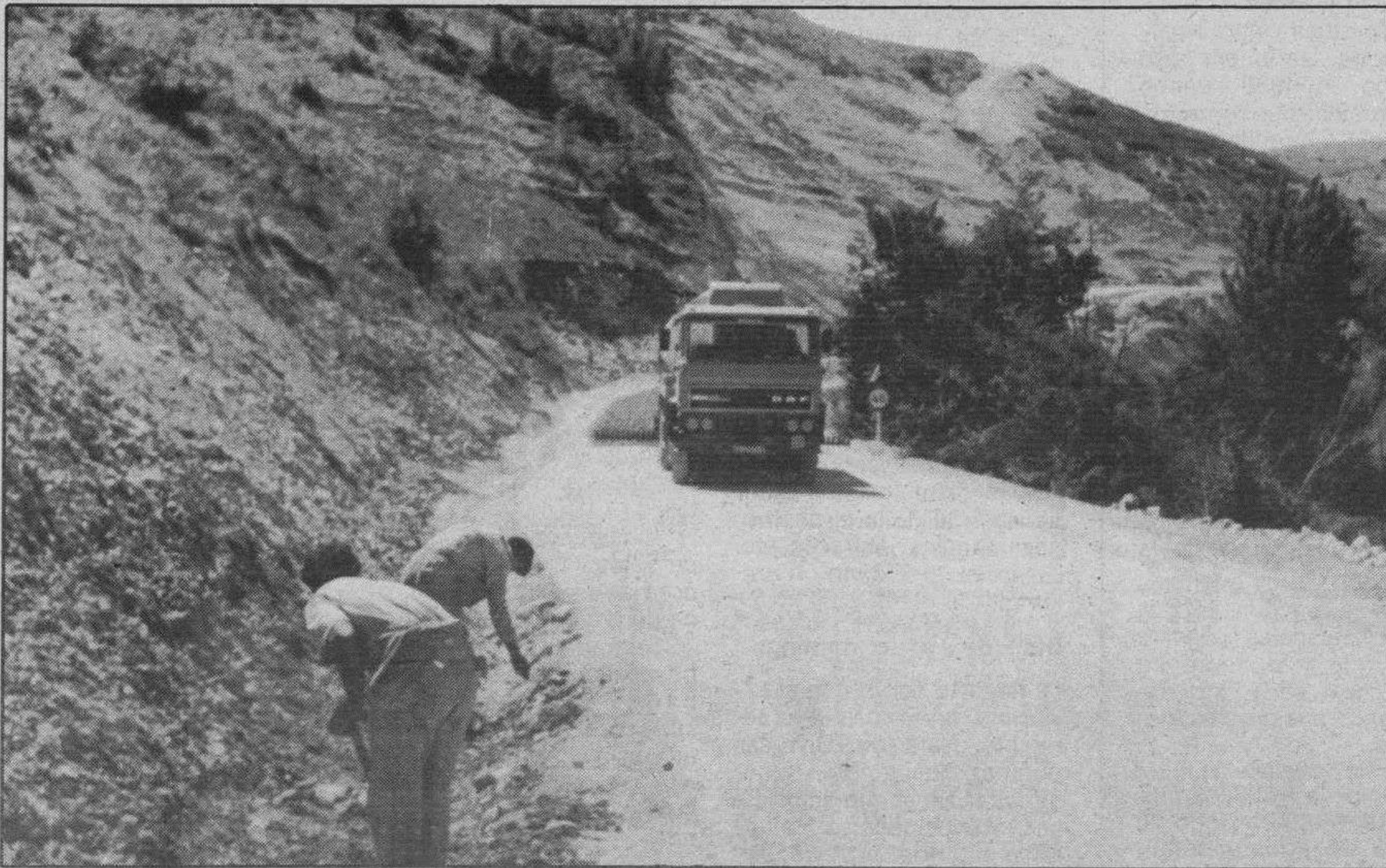
Remate de los trabajos en la carretera El Tozo-La Lora junto a Barrio Panizares.
