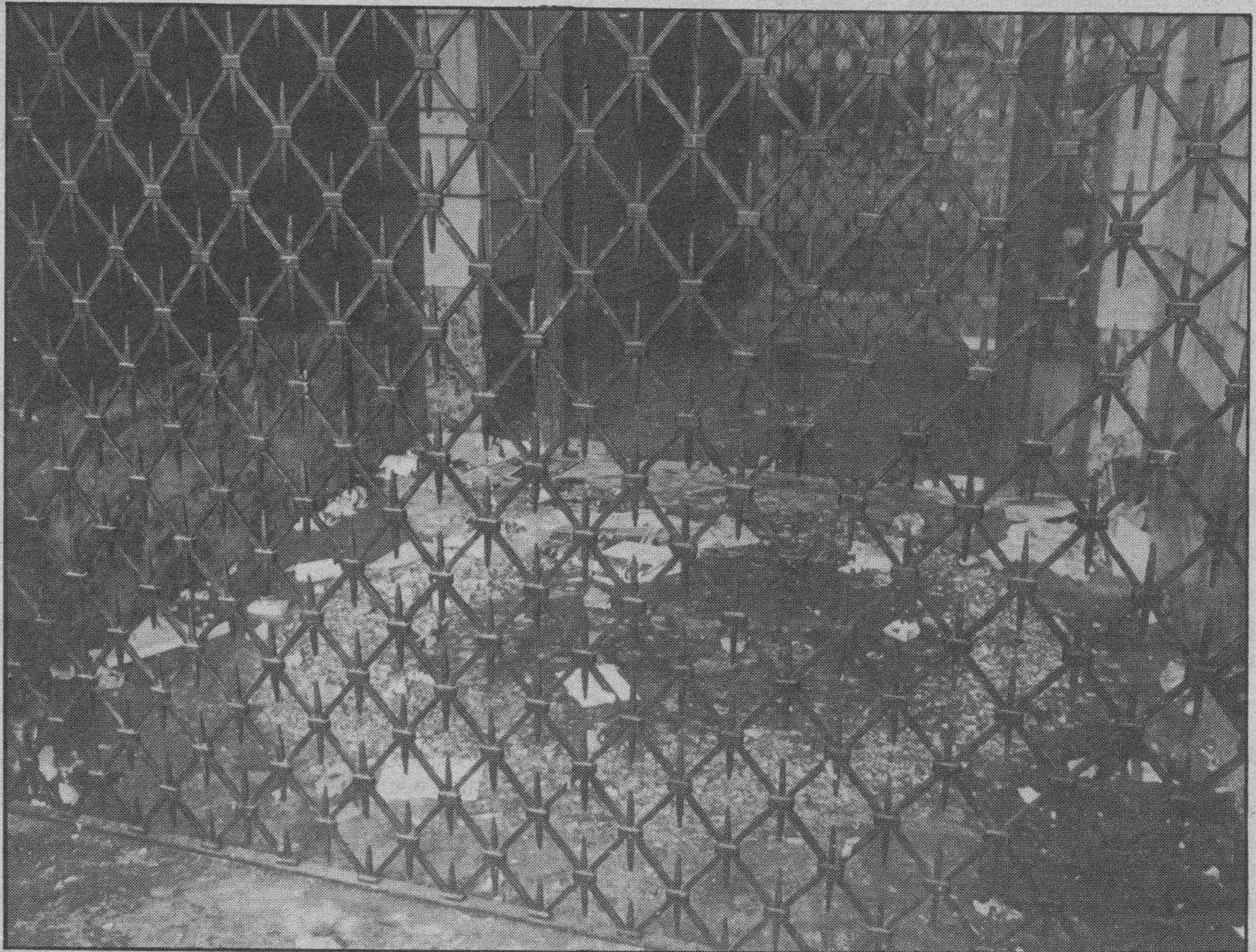
Vertedero. — En Plaza Mayor y en un comercio cerrado se halla este vertedero. Las tejas sirven para proteger el comercio y la basura y residuos que se arrojan sin ningún miramiento. Más de una persona nos ha llamado para que alguien ponga remedio o limpie el lugar. Tendrá dueño ¿no?
