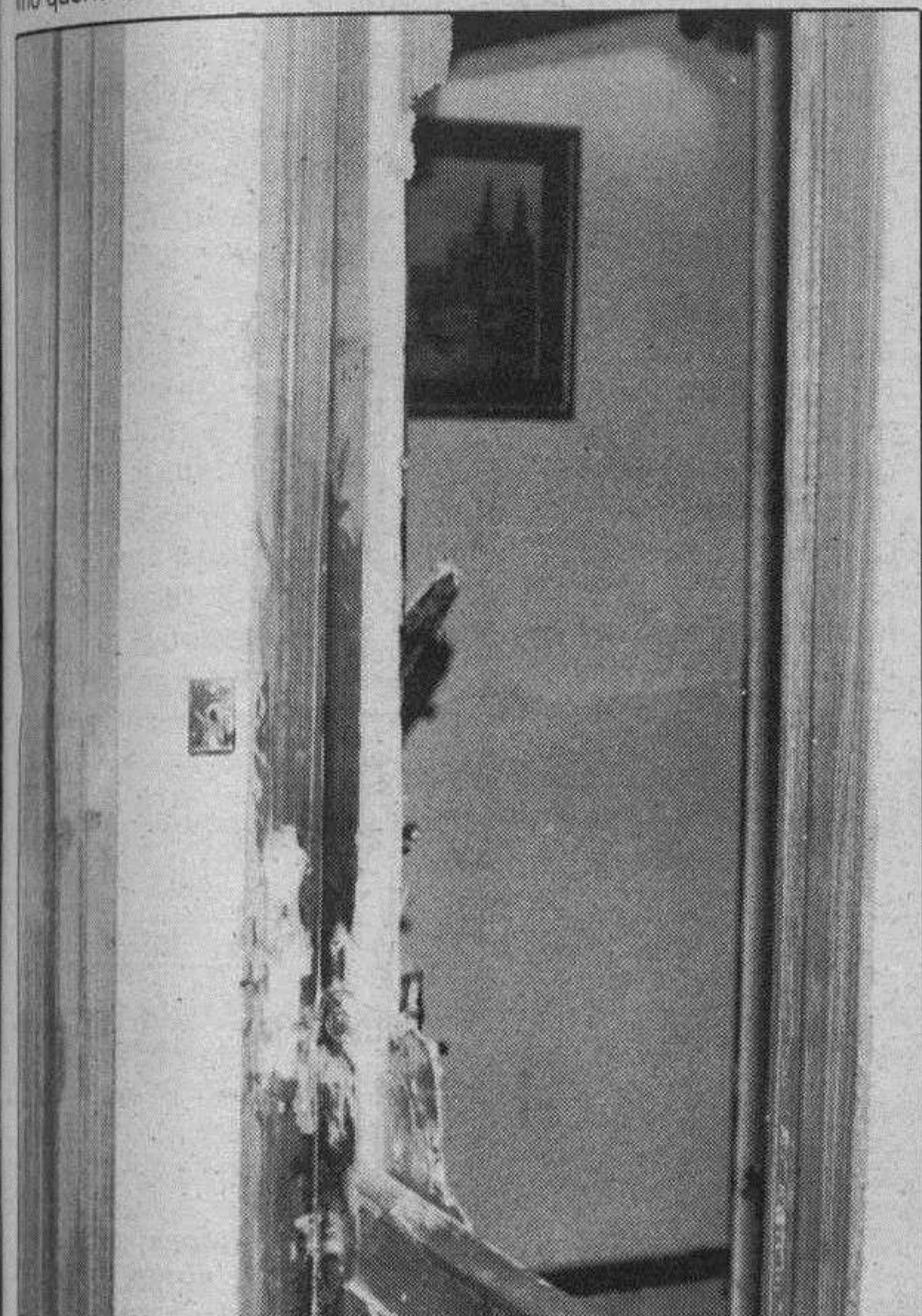
La puerta del domicilio forzada por los bomberos.
