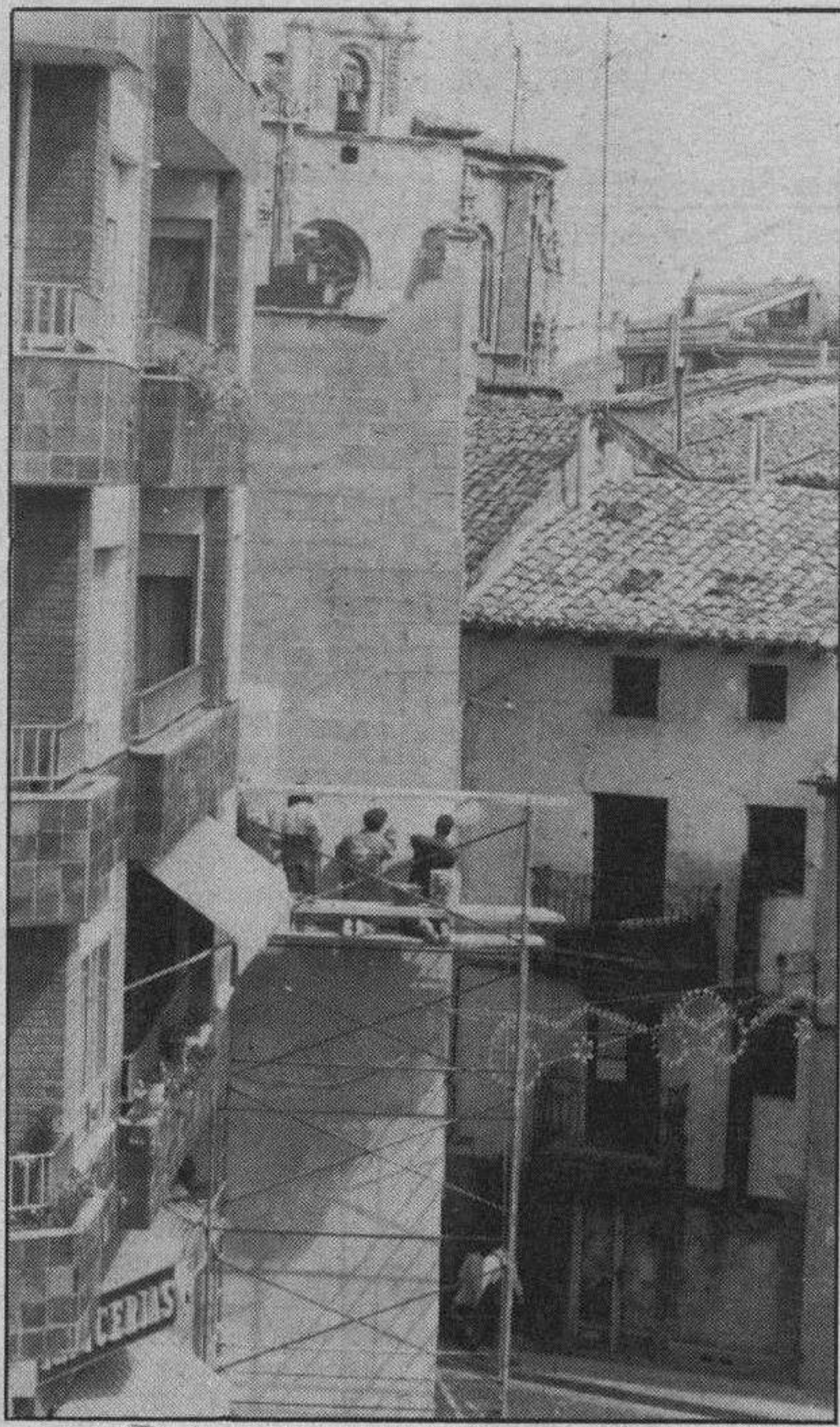
Pintando la mediana. — Como ya anunciamos hace unas semanas, la mediana que se veía, toda estropeada nada más entrar por el puente del Duero, bajo el arco del Ayuntamiento, está siendo adecentada convenientemente. En aquella época comenzaron las obras de revoque con cemento y ahora se están llevando a cabo las labores de pintado. El caso tiene su importancia ya que está en un lugar muy céntrico y su descuido desde hacía mucho del entorno del casco viejo. Decían que la iban a pintar de acuerdo con este entorno y la verdad es que le están dando un tono anaranjado en forma de ladrillos que no se sabe muy bien que resultado ofrecerá al final. Probablemente algo llamativo. En cualquier caso, una obra más terminada. Foto Lara.
