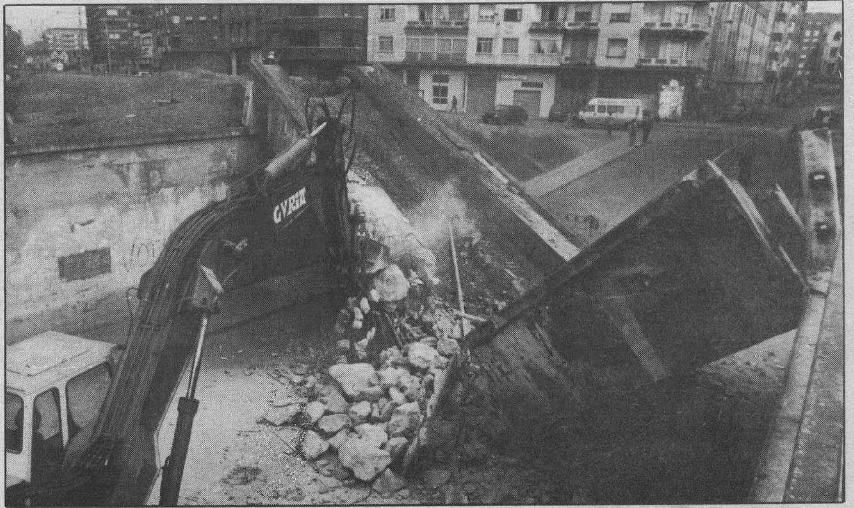
Derribado el puente de Ocaña, en Miranda. — Con el derribo del puente de Ocaña en Miranda, que recoge la fotografía de Truchuelo, se puede afirmar que han comenzado las obras de la primera fase de urbanización de la Ronda del Ferrocarril en la citada ciudad, una vieja aspiración que también tiene Burgos, pero que nadie sabe aquí cuándo será posible hacer lo mismo.
