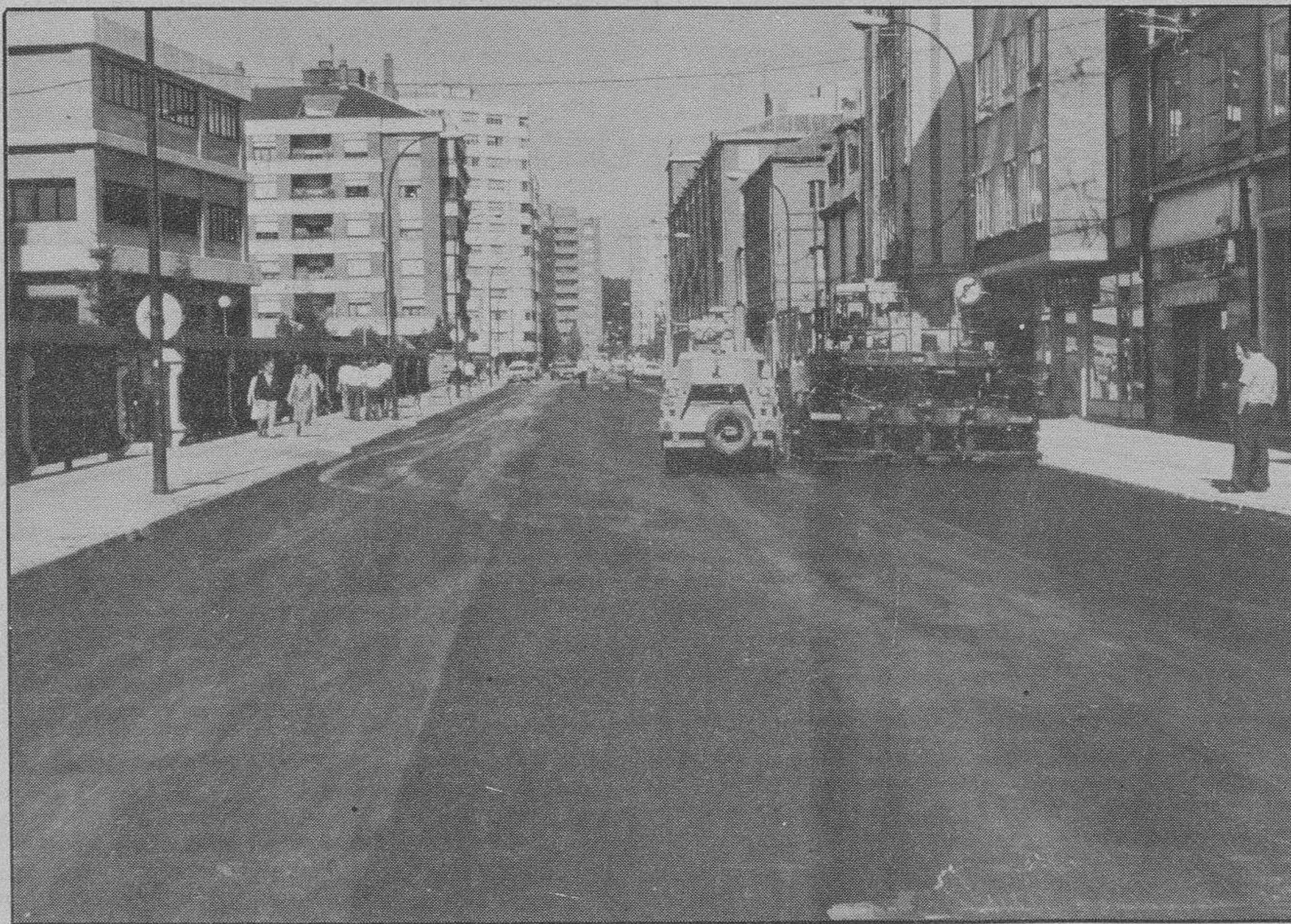
Campaña Aglomerado 87. — El Ayuntamiento ha iniciado la Campaña Aglomerado 1987 mediante una empresa adjudicataria de las obras que tienen un presupuesto de unos 18 millones de pesetas. La fotografía ha sido captada durante los trabajos de regeneración asfáltica de la calzada de la calle Segovia, a la que seguirán otras muchas vías públicas en el centro y en la periferia de la ciudad.
