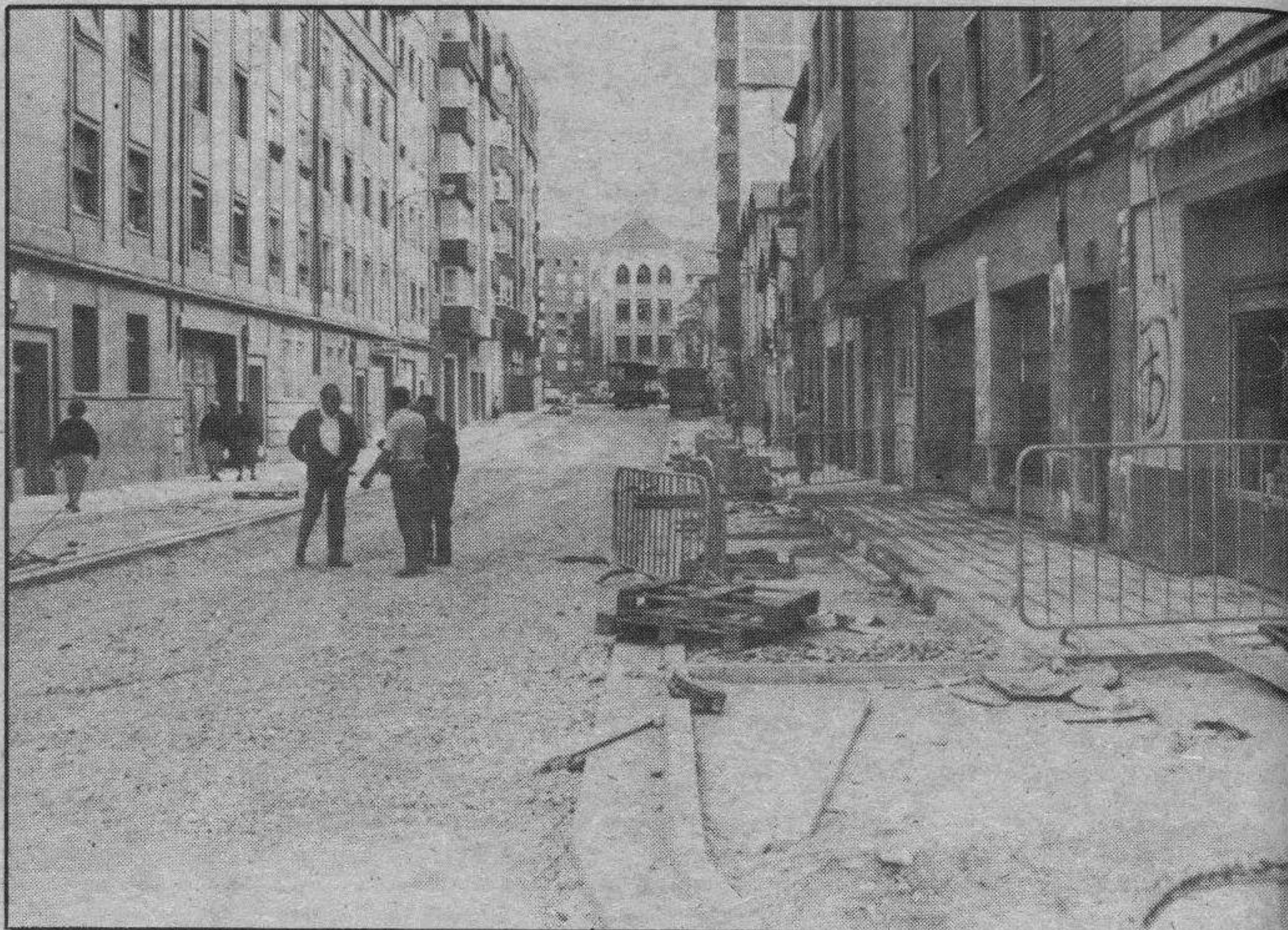
Arenal. — Debajo quedaron las enormes tuberías de los nuevos colectores y también los muchos días de tener que soportar molestias y llenar las casas de barro transportado en los zapatos. Ya, la obra está en su última fase. Como puede apreciarse en la foto de Truchuelo, ya están «echando» las aceras y la calzada está a falta del asfaltado. Se trata del tramo de Arenal, desde el llamado puente de Ocaña a la calle de San Agustín.
