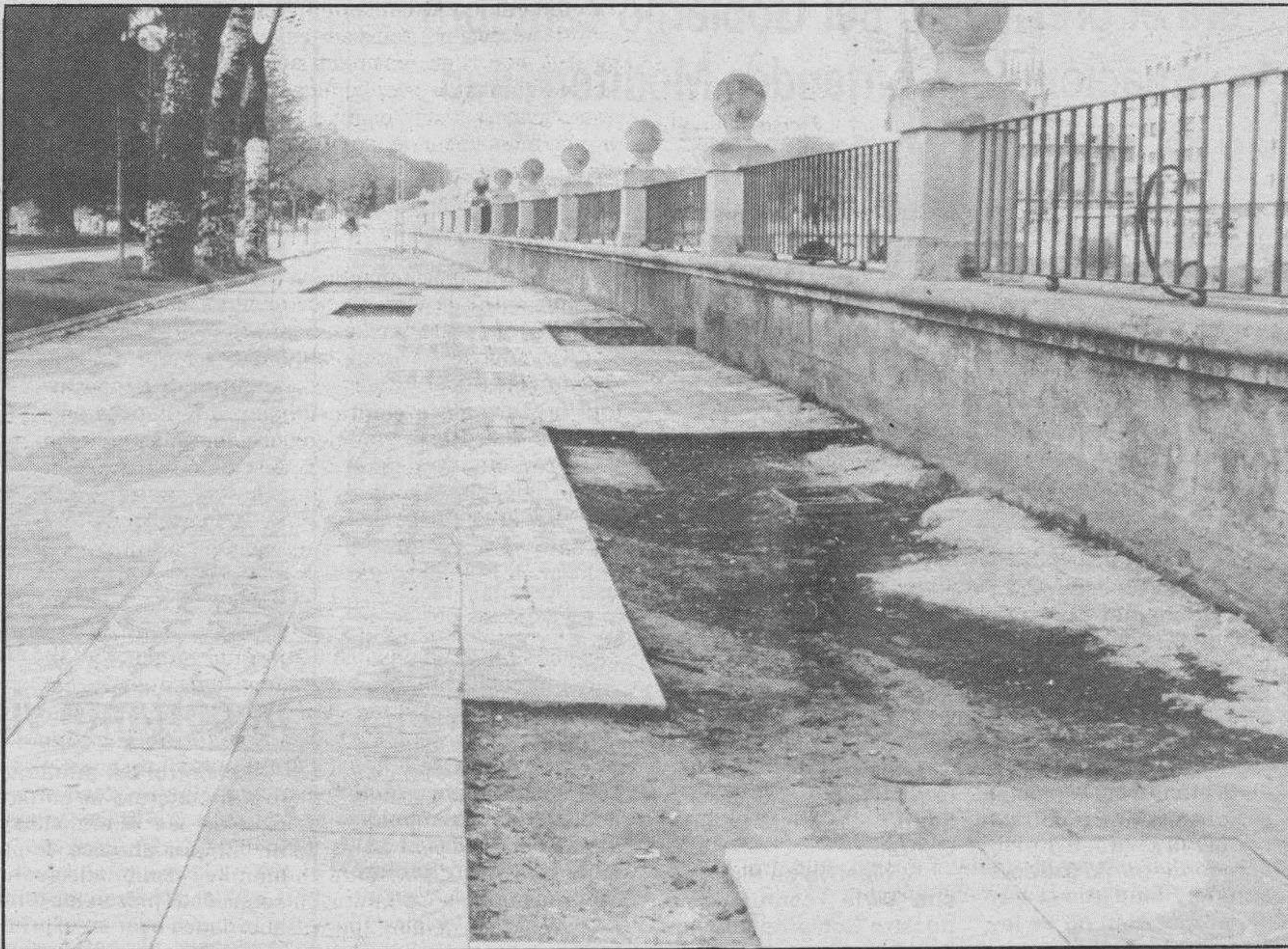
Faltan unas baldosas. — No se remató la obra y cabe pensar que ahora que el tiempo puede «sentarse» se llevará a cabo la obra de conclusión del embaldosado que se levantó para corregir los hundimientos habidos en el Arlanzón, a la altura del Paseo del Conde de Vallellano.
