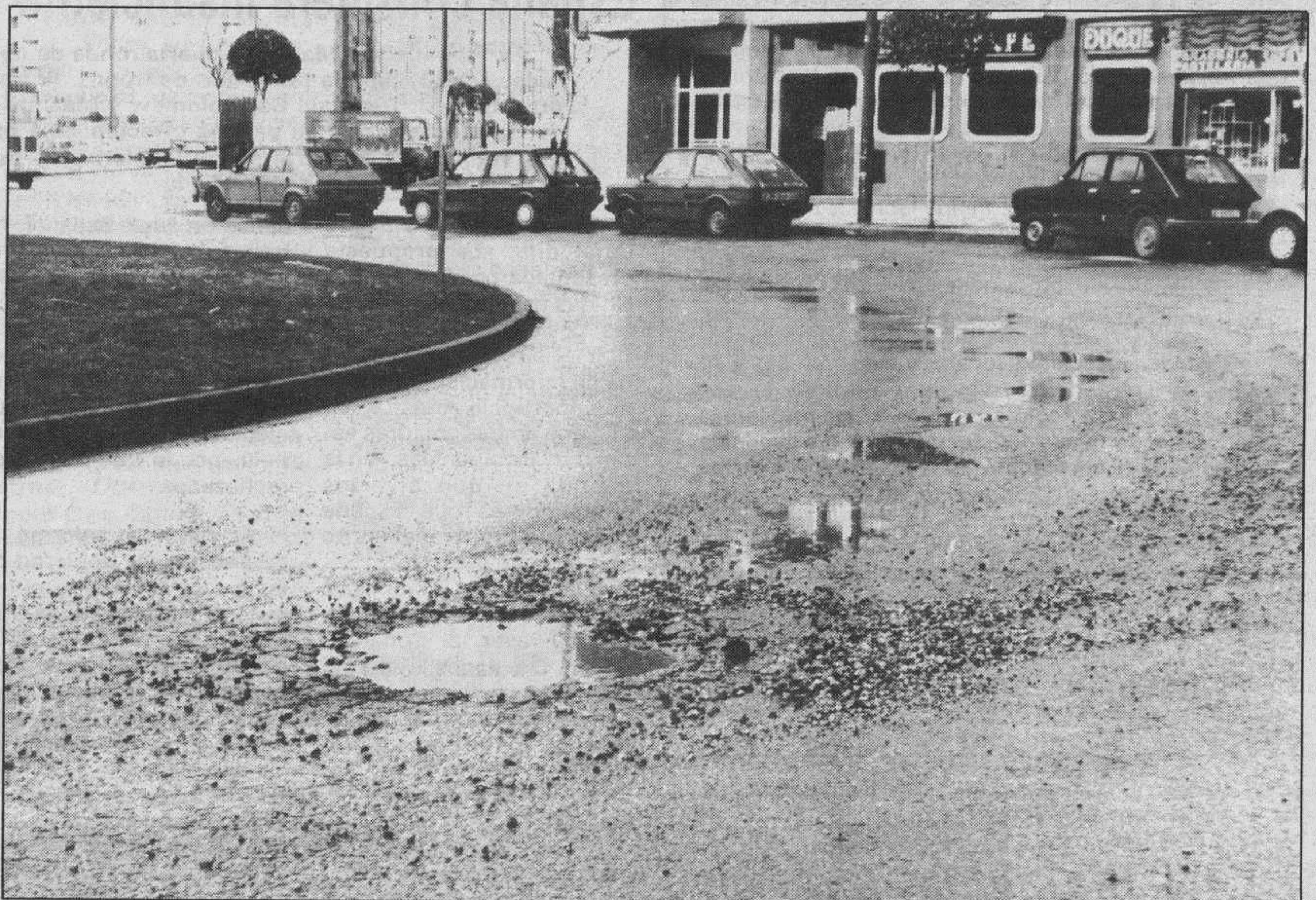
Los efectos del invierno. — Es indudable que nuestro clima plantea muchas dificultades para la conservación y el mantenimiento del firme de las calles y carreteras. Las fuertes heladas de semanas anteriores han causado serios destrozos en el pavimento y para muestra basta sólo este botón. Las diferentes Administraciones tendrán que habilitar presupuestos especiales dedicados a reparar estas vías en la próxima primavera.
