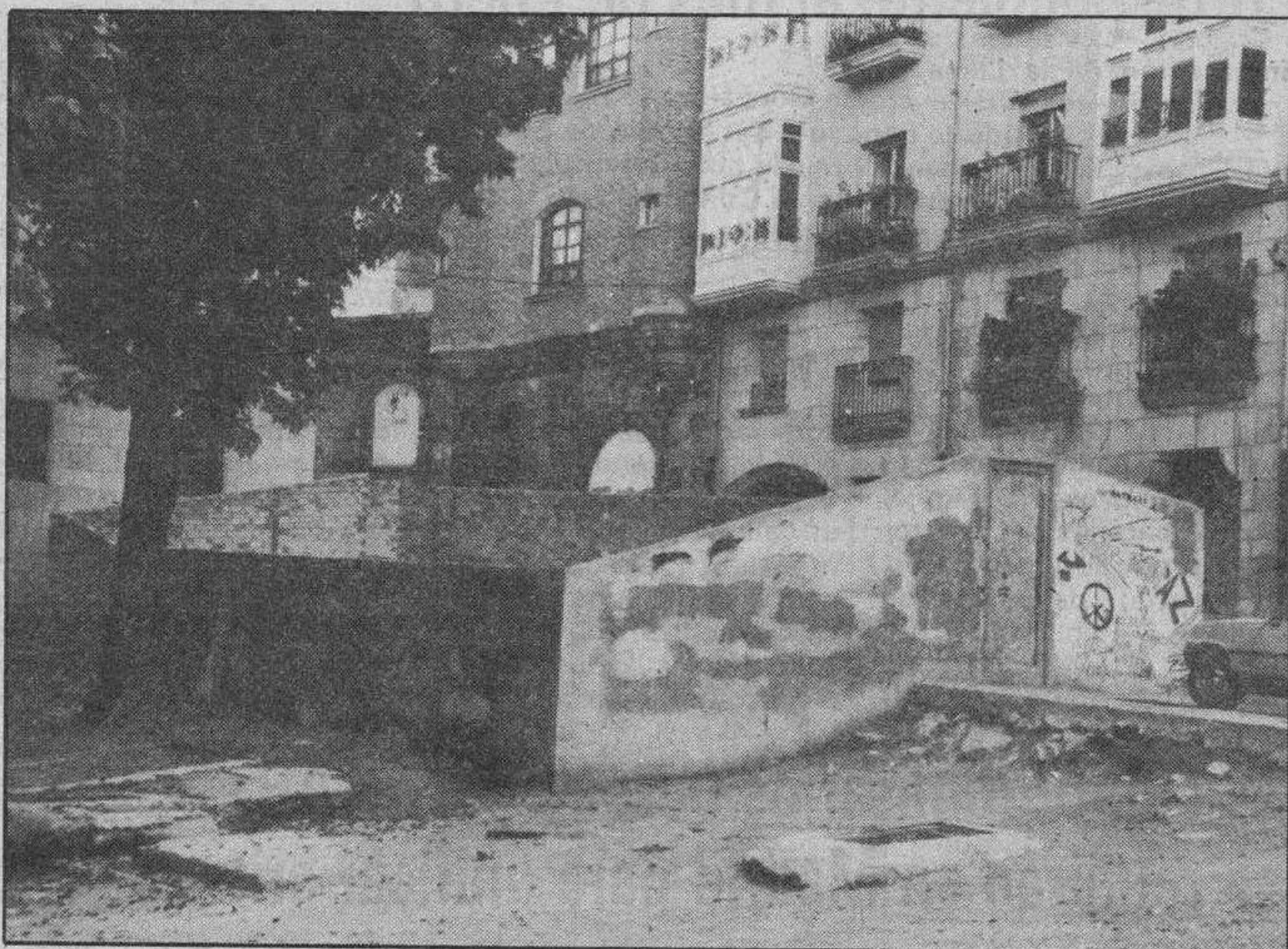
Las obras de urbanización de la plaza de los Castaños, que ayer fueron adjudicadas, deberán estar concluidas en el plazo de tres meses
