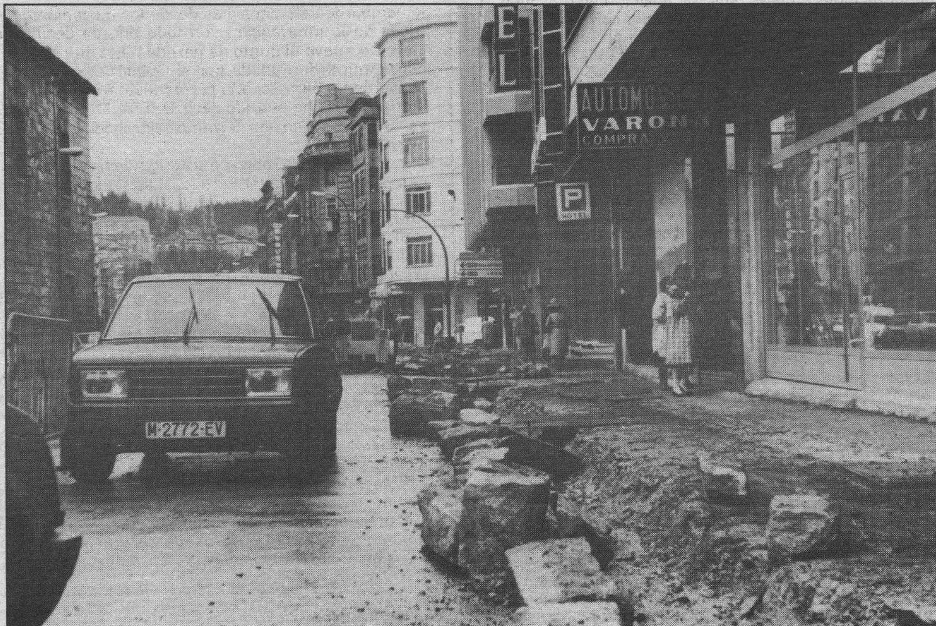
Perfilando bordillos.— Puede parecer una obra auxiliar, complementaria y sin importancia. Acaso no lo sea así. Se trata de trabajos que realiza la brigada municipal de reparación y reposición de bordillos, desde el paso a nivel de la calle Madrid —donde estaban hundidos— hasta la manzana frente al Hospital de la Concepción y la calle General Mola. No tiene gran importancia, si cuanto supone poner al día el urbanismo, aquello que es mejorar la red viaria urbana, la frontera que existe entre automovilistas y peatones, que no siempre respetamos ni cuidamos.
