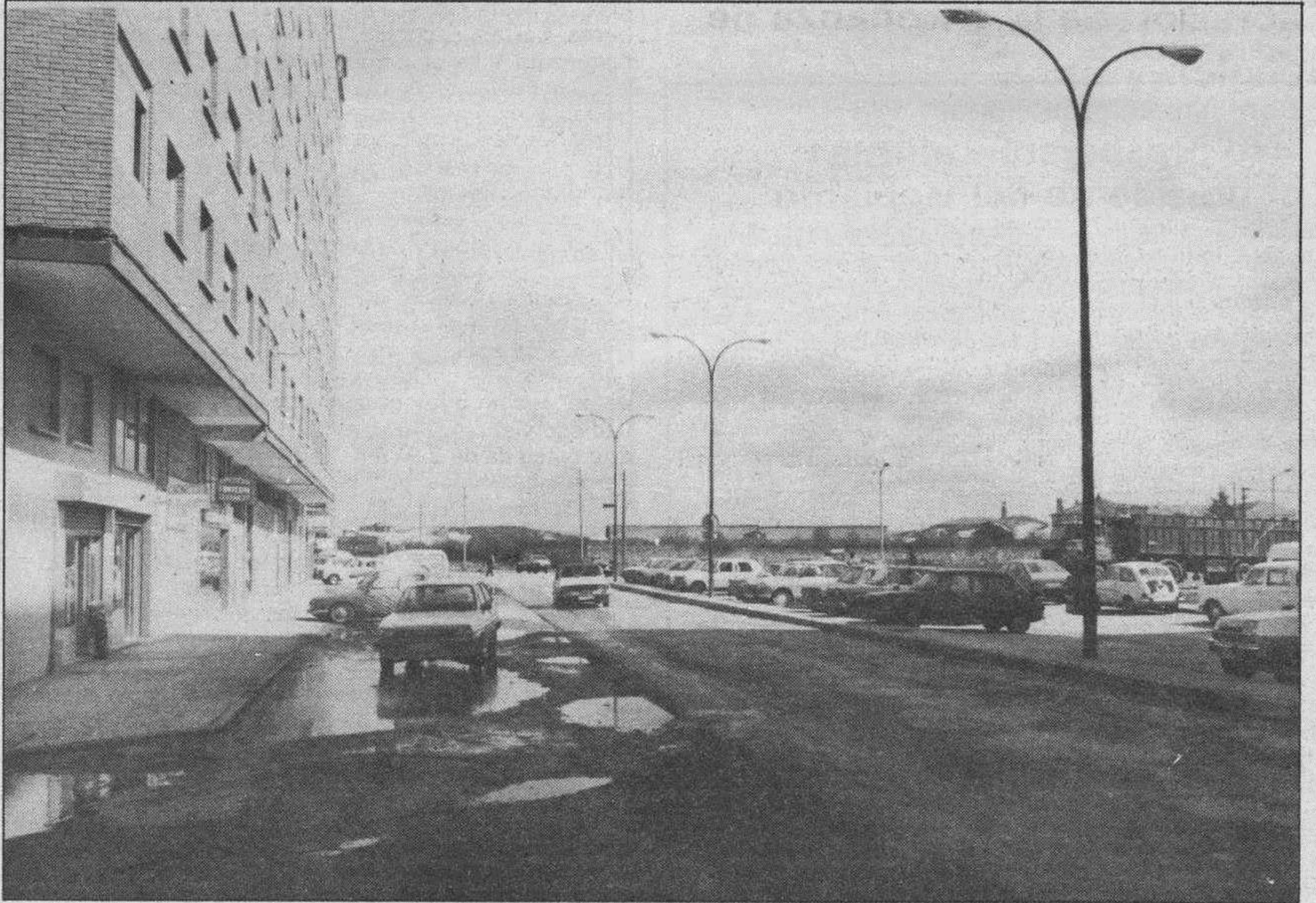
HUELLAS DEL INVIERNO. — Los rigores del clima burgalés dejan su huella en el asfalto y ésta es una muestra más. La brigada municipal de obras tiene trabajo para esta primavera en algunas zonas de la ciudad y ésta que les presentamos parece evidente que precisa de esos arreglos. Así está la calle Carretera de Poza.
