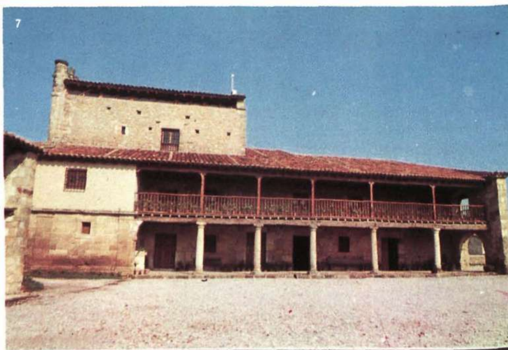
7. Restauración efectuada en la «Torre de la Beltraneja, en su parte exterior.
