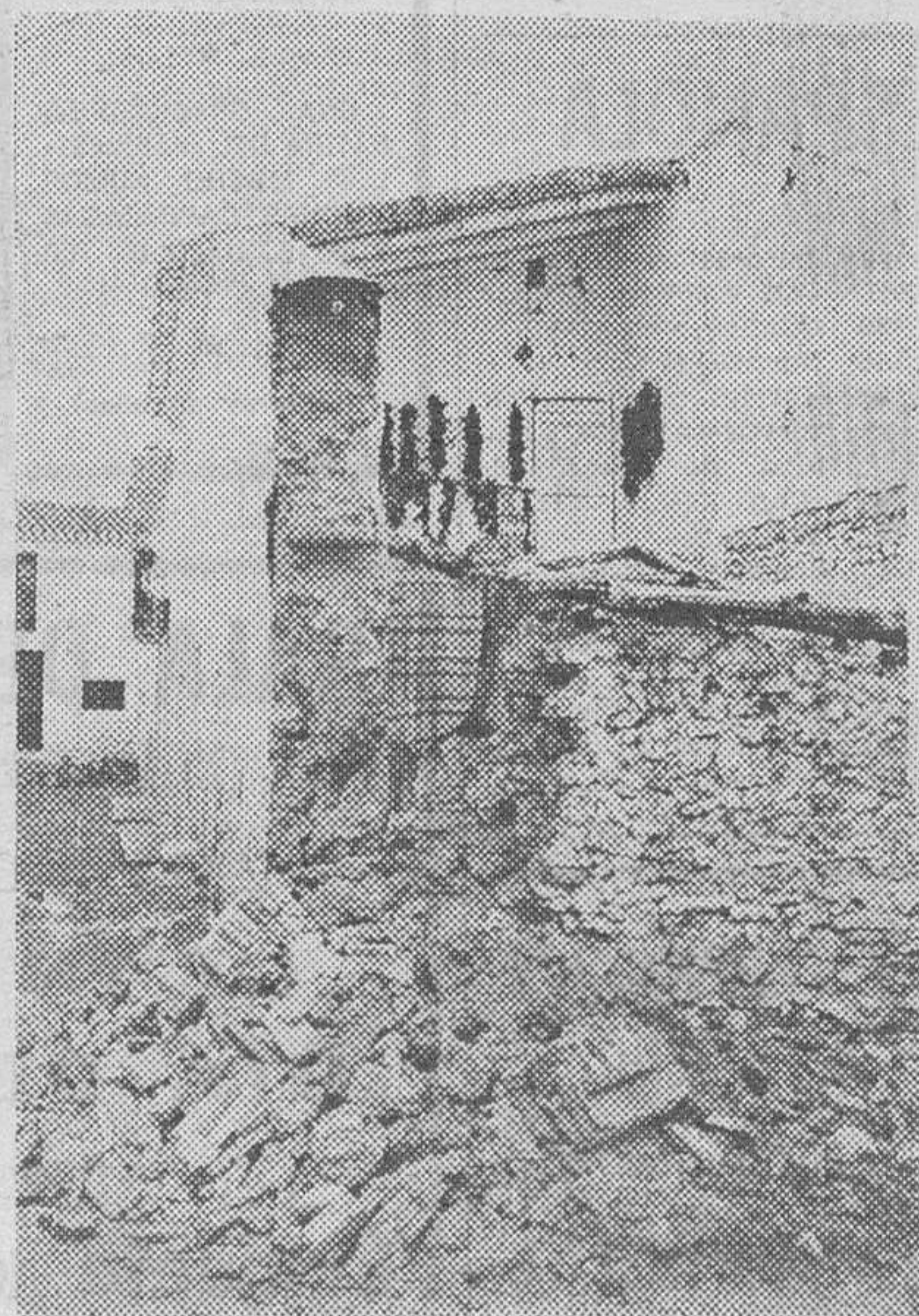
Partalao (Almería). — Un centenar de viviendas incluida la iglesia de este pueblo han quedado seriamente dañadas al derrumbarse sus techumbres o presentar profundas grietas en sus paredes y tabiques a causa del seísmo registrado el pasado 17 sobre las 9 de la noche. En la foto, una vista de los destrozos registrados en las viviendas de este pueblo. (Foto CIFRA GRAFICA)
