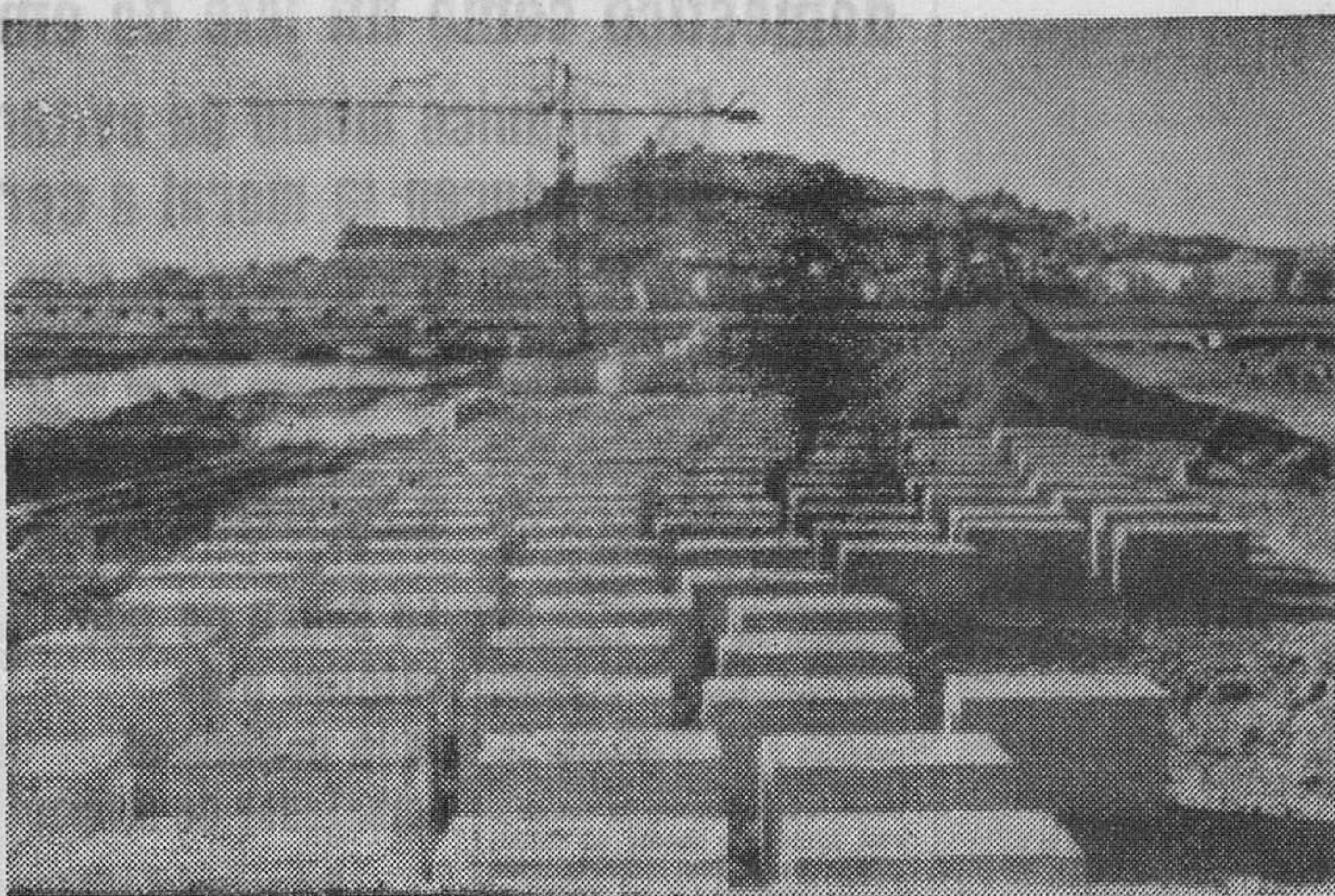
He aquí un aspecto de las obras de construcción del paseo Marítimo en la ribera Norte del puerto de Ibiza. Las obras siguen el ritmo previsto y se cree que podrá inaugurarse en la primavera del próximo año.
