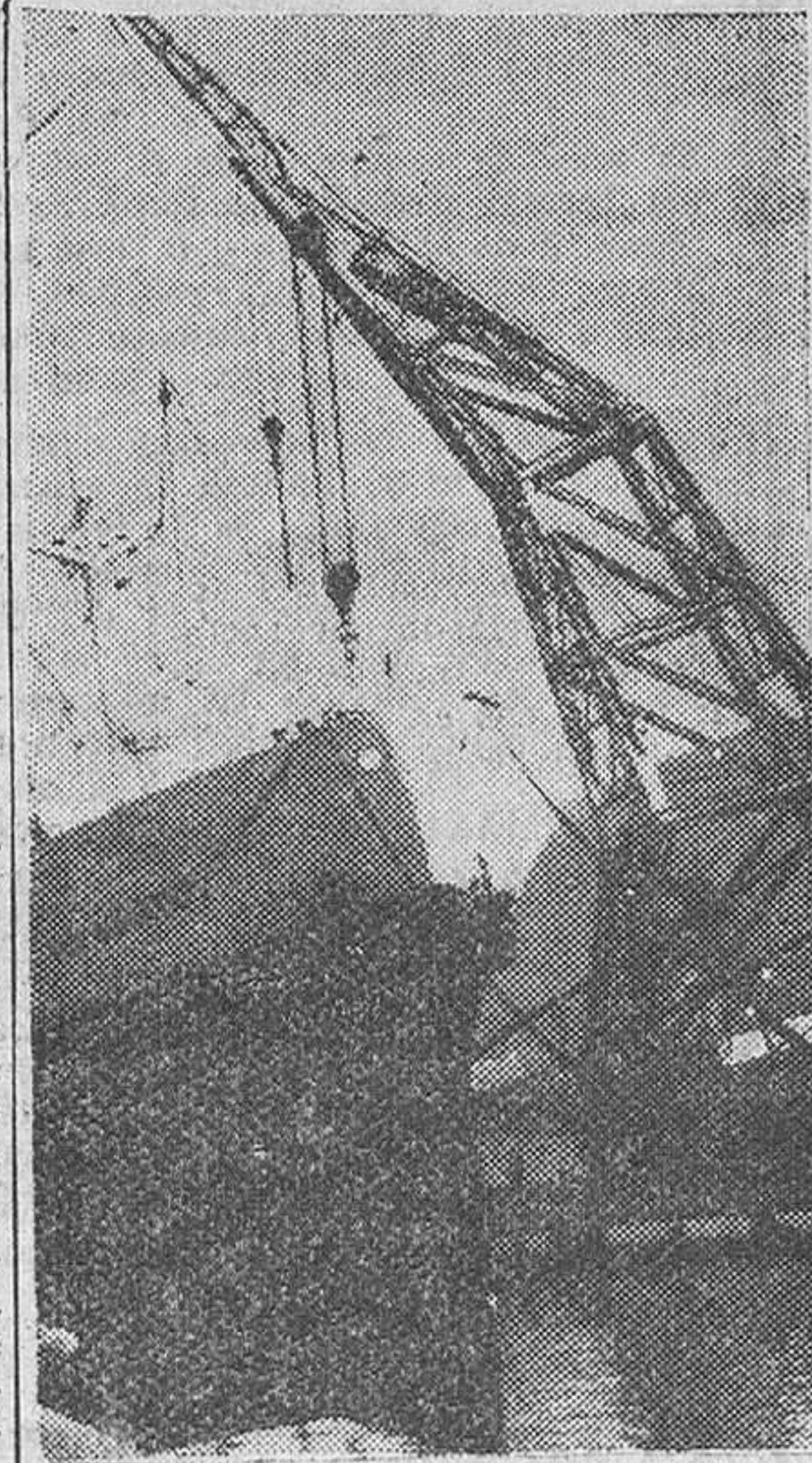
Bilbao.—Las grúas del puerto, mas la cabria, de cien toneladas, de la Junta de Obras proceden a descargar del vapor «Mar Adriático» la maquinaria llegada para los sondeos petrolíferos que se realizan en Navarra (Foto Cifra)
