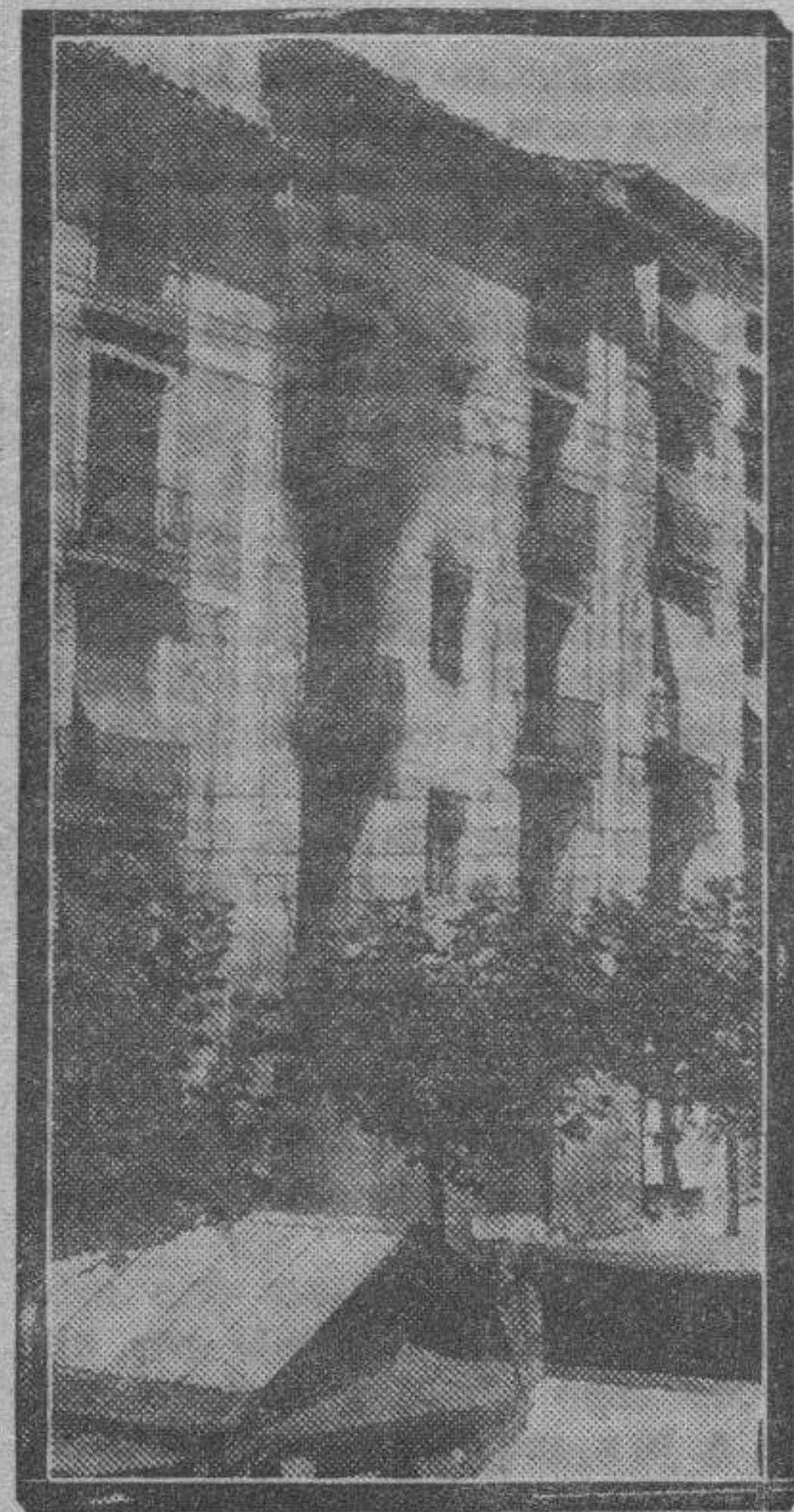
La casa de la plaza de San Antón, propiedad de "Sobrinos de Celestino Valero", en donde anteanoche se produjo un violento incendio, ocasionando pérdidas de gran consideración. (Foto. A. de la Barrera)
