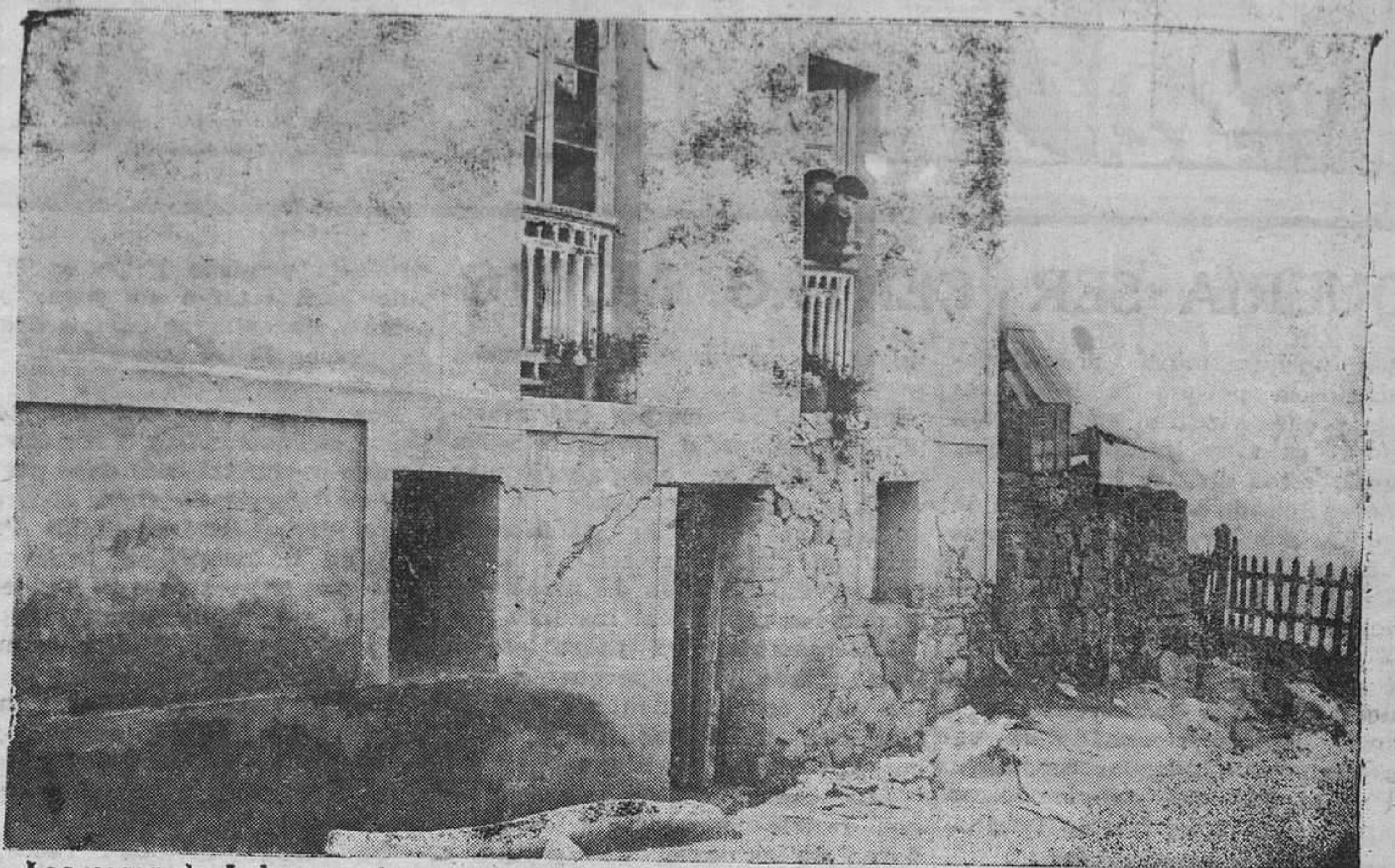
Las casas de Labayos, al moverse el suelo sobre que se asientan, van resquebrajándose, rompiéndose. La "foto" muestra uno de los edificios con las enormes grietas que ofrece en su base (Foto Tuero)
