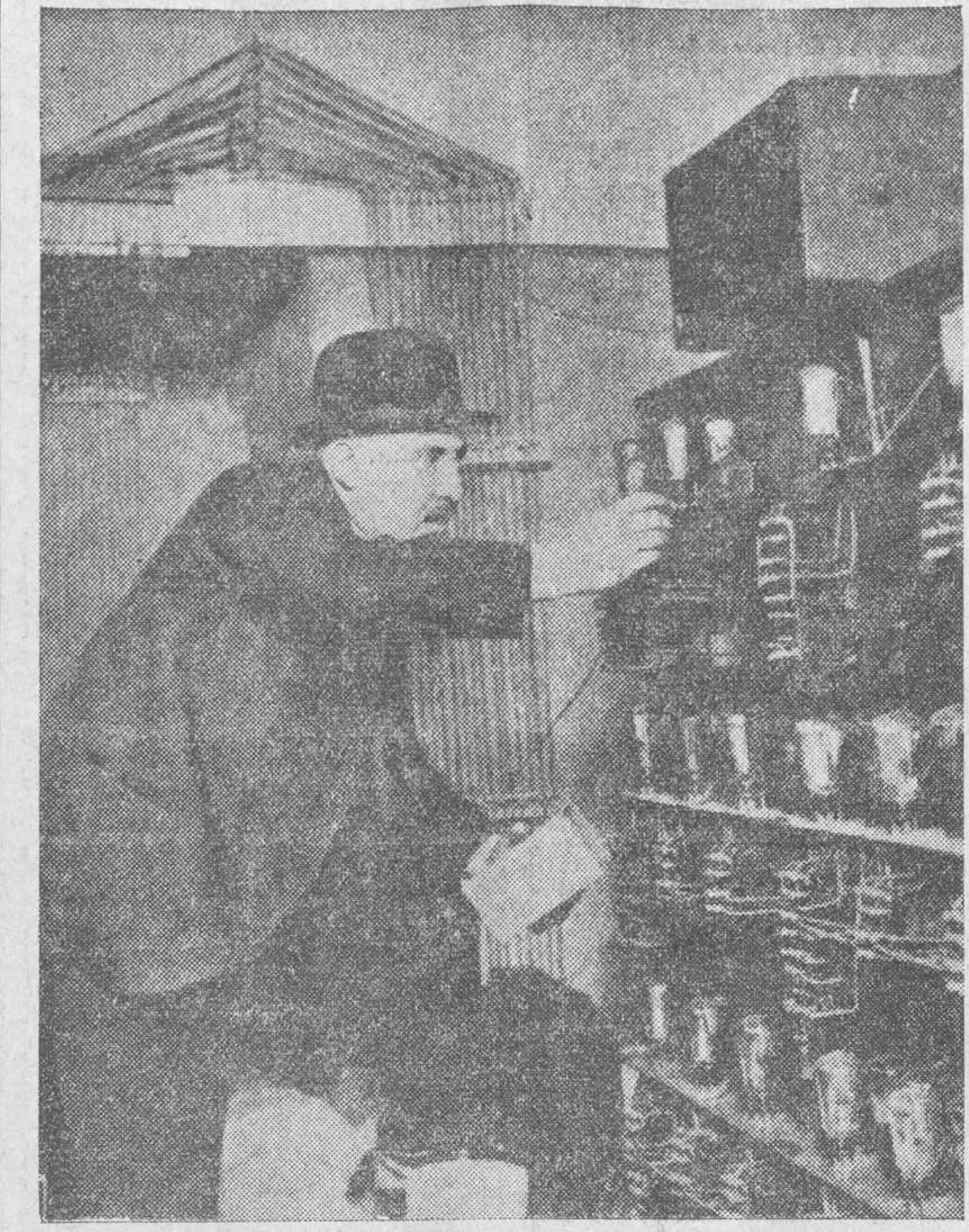
Instalación de radio para la recepción de los programas de «broadcasting» en un edificio de 200 departamentos, en Londres. El aparato funciona con cuatro válvulas y por medio de cuarenta y seis amplificadores. Con un simple toma-corriente se pueden recibir las comunicaciones en todos los departamentos
