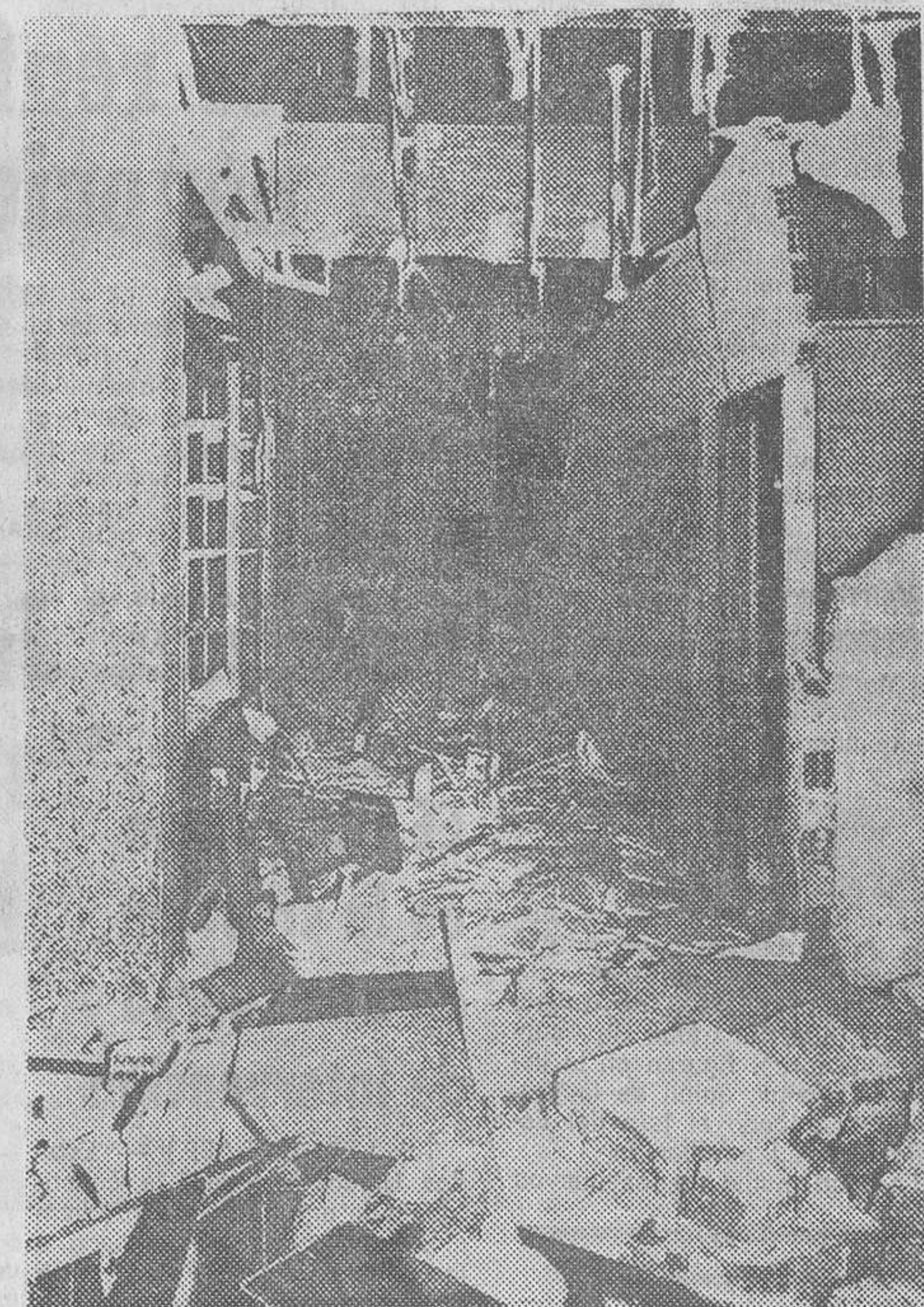
Aspecto de una de las habitaciones de la sede de Euzkadiko Ezkerra en San Sebastián, que ayer sufrió grandes destrozos a consecuencia de la explosión de un artefacto. — (Foto Efe)
