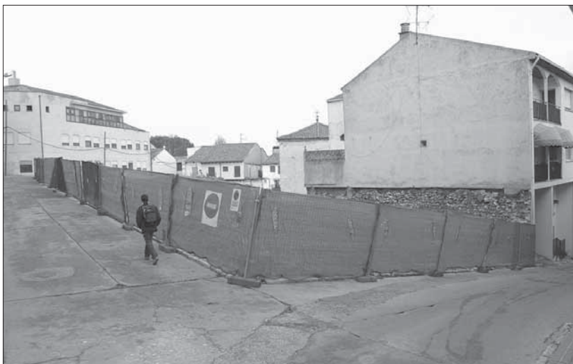
Los problemas surgidos con la cimentación de los edificios colindantes llevaron a parar la obra./GABRIEL GÓMEZ
