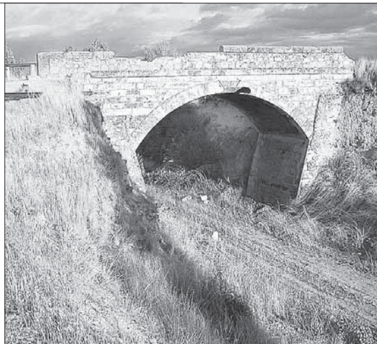
Estado actual del puente de Armuña, por el que pasaba el tren. (EL ADELANTADO)
