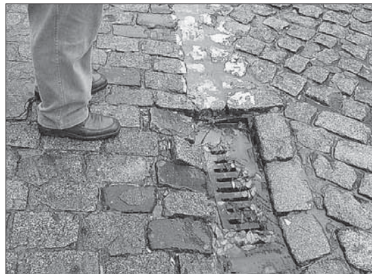
Imagen de una alcantarilla sucia en una calle de la ciudad. / FERNANDO PEÑALOSA
