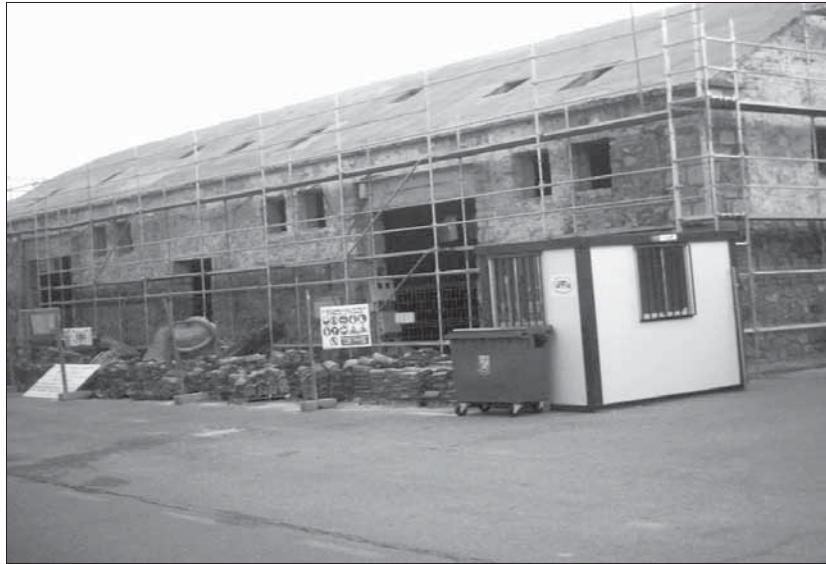
Aspecto actual de las obras del futuro Museo de Trilleros, que han estado paralizadas. / JOSÉ LUIS ACEBES
