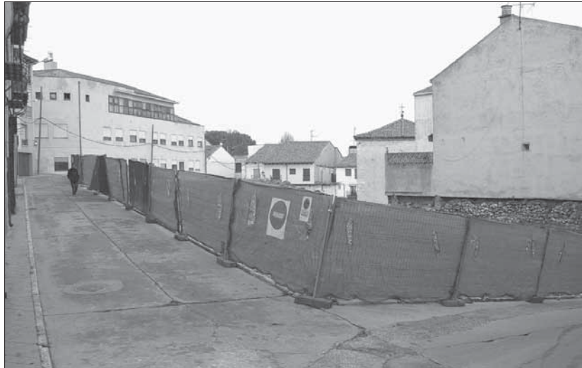
Las obras en el área se encuentran paradas por problemas en la cimentación/GABRIEL GÓMEZ
