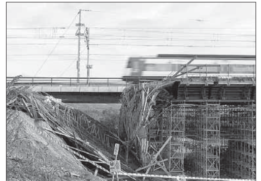
El puente donde se derrumbó parte del forjado. / EFE
