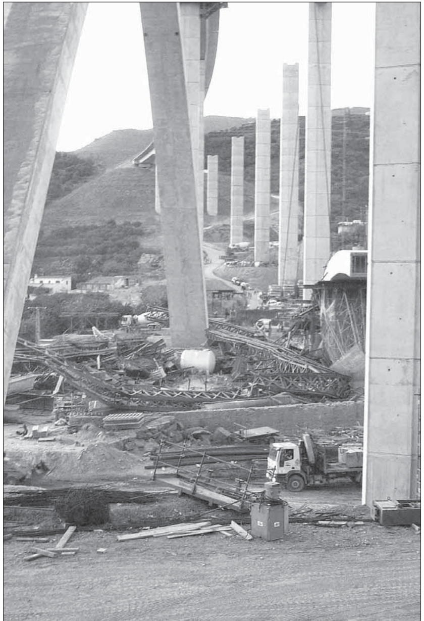
La plataforma desprendida quedó al pie del viaducto, convertida en un amasijo de hierros. / EFE
