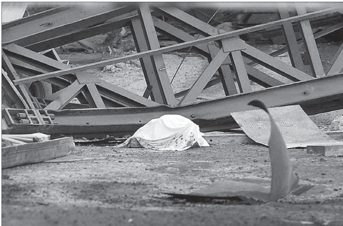
Uno de los fallecidos en el accidente que se produjo tras derrumbarse una plataforma en las obras de la Autovía del Mediterráneo. / JUAN FERRERAS (EFE)
