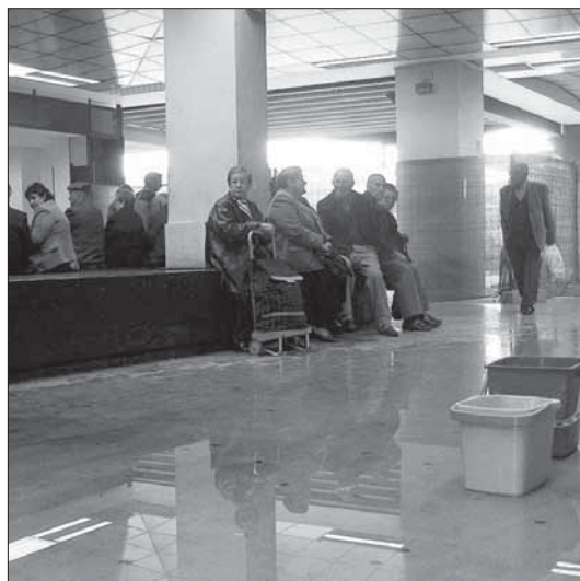
Filtraciones en el vestíbulo de la estación de autobuses
