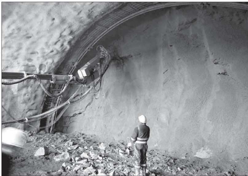
Dos imágenes de archivo de la excavación del tercer túnel para la autopista AP-6 bajo la Sierra de Guadarrama, en la boca de una de las vertientes y en el interior de la infraestructura
