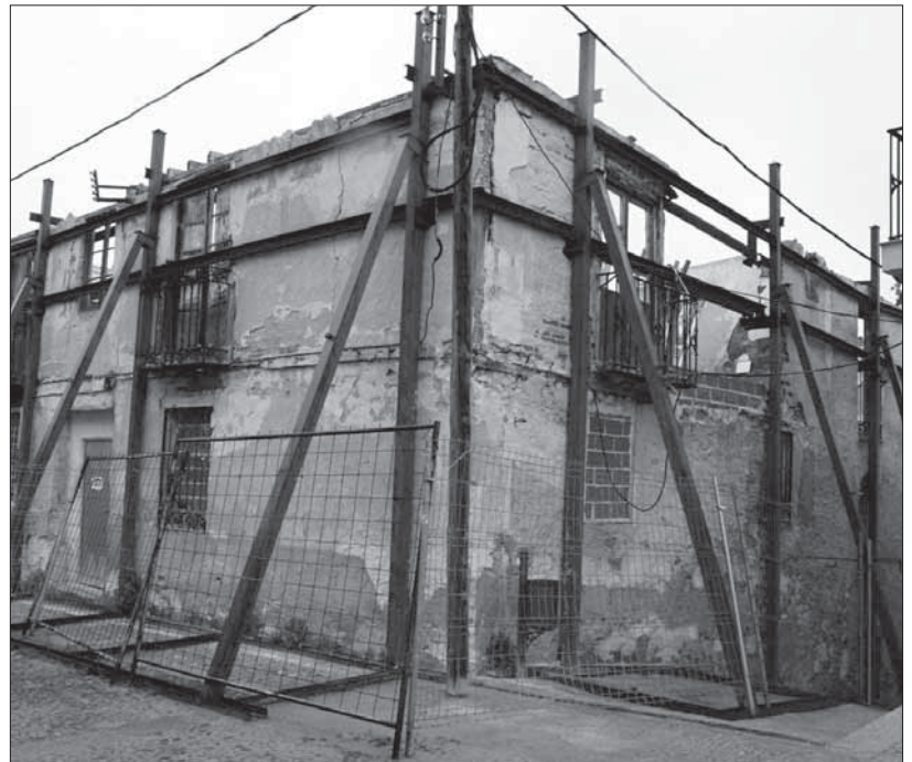
El edificio solo conserva los muros de su planta baja, sujetos con pilares verticales metálicos PENALOSA
